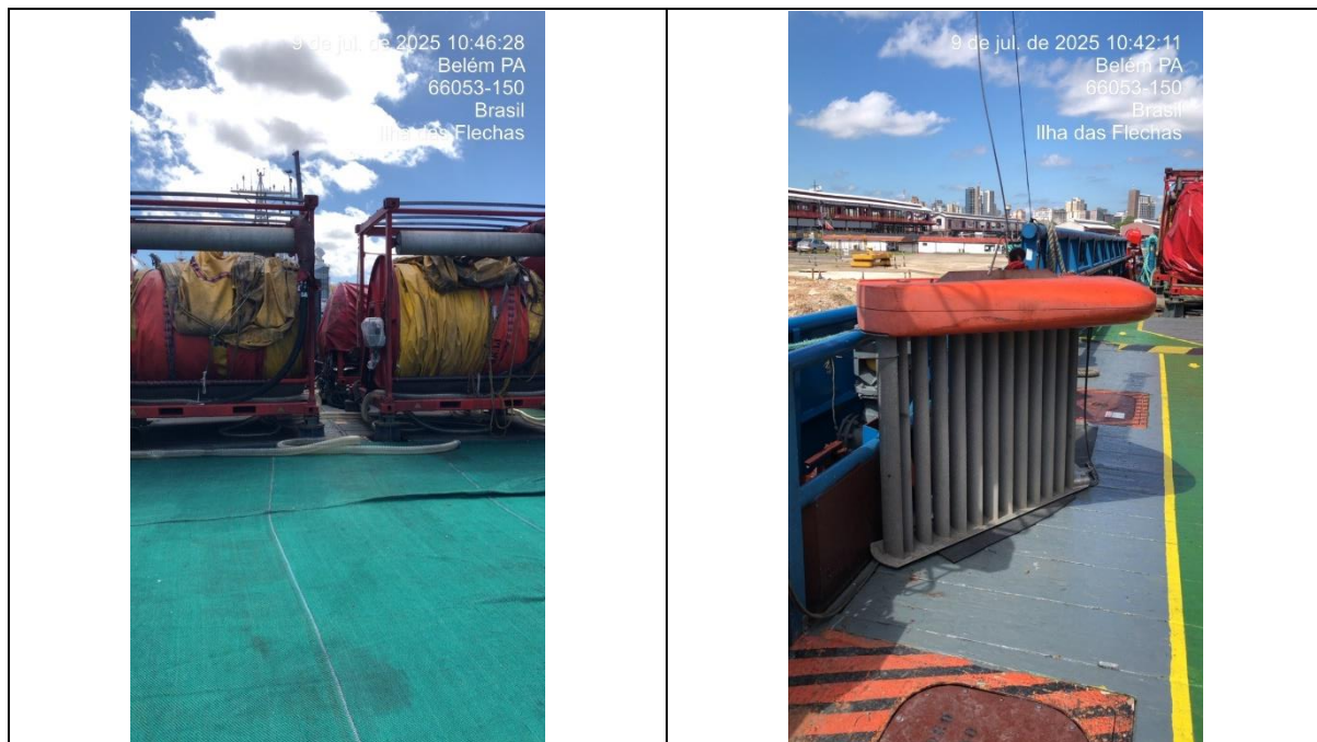
Item 14 - Equipamento CB-06 (principal e sobressalente)
