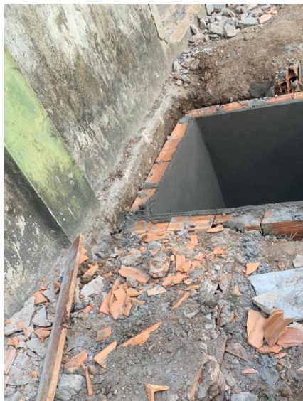
Caixa de passagem elétrica
