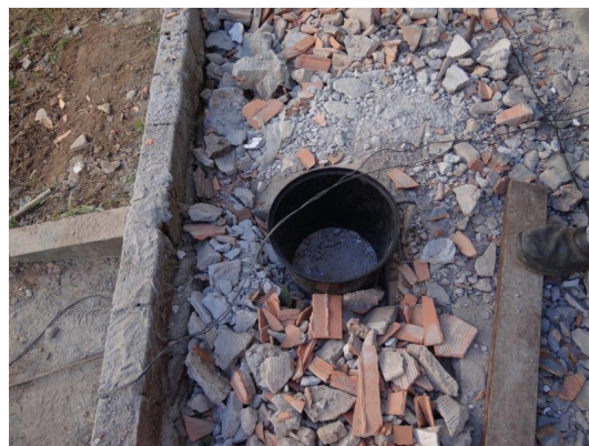
Caixa de aterramento
