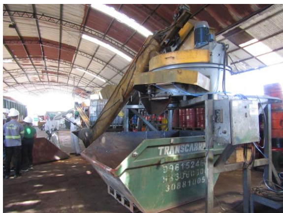
Fig.9 - Galpão 3 – Setor de blendagem – caçamba receptora do blend
