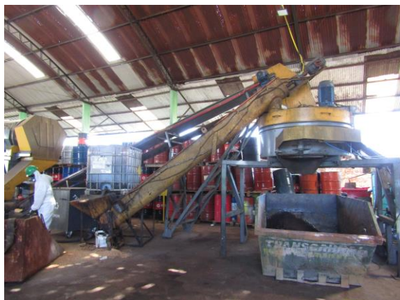
Fig.11 - Galpão 3 – Setor de blendagem – visão geral do sistema de blendagem
