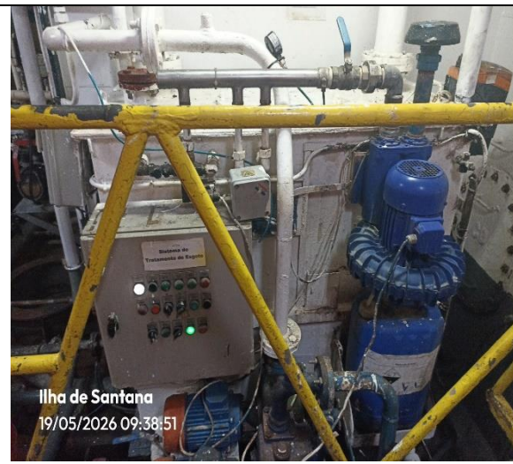
Sistema de tratamento de esgoto
