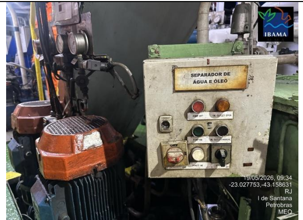
Separador Água e Óleo - SAO
