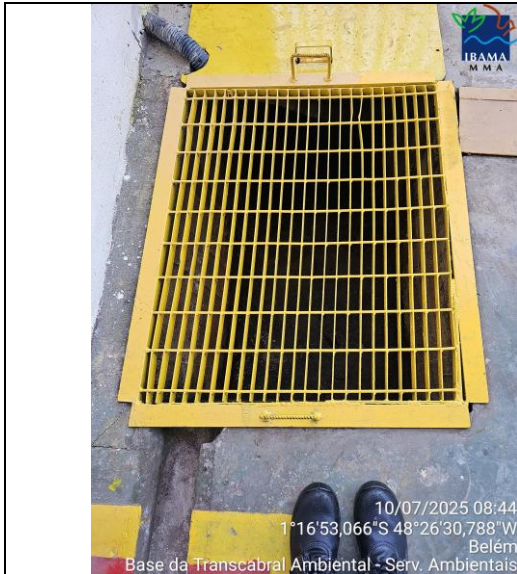
Caixa de contenção de efluentes
