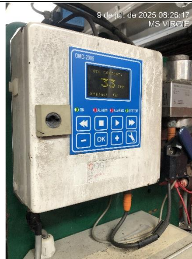
Item 8 – SAO: Teste do Alarme
