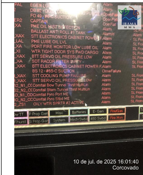
Item 8 – SAO: Teste – Alarme no sistema na Sala de Máquinas
