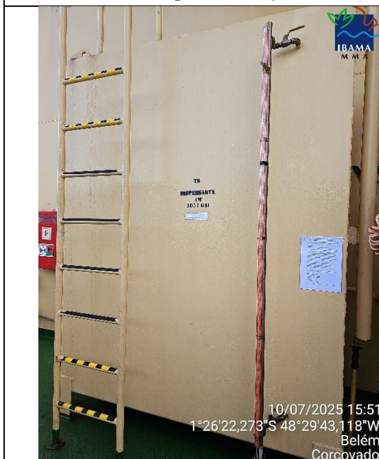
Item 14 - Tanque para armazenamento de Dispersantes - COREXIT
