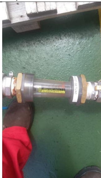
Item 15 - Conexão do mangote do recolhedor de óleo ao manifold do tanque ORO
