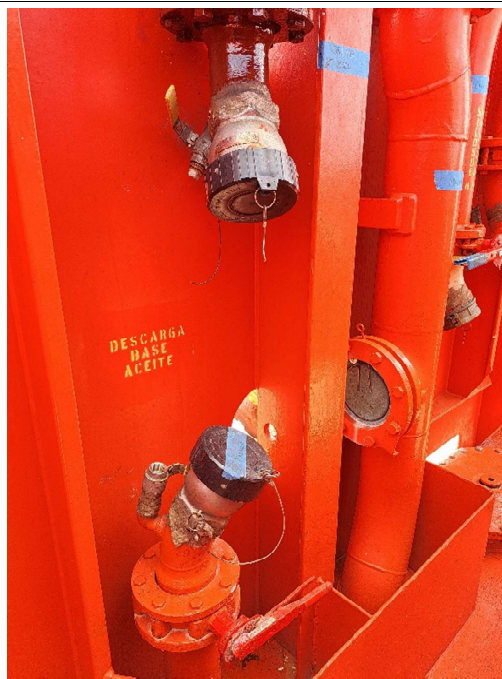
Foto 13: Sistema de abastecimento de diesel
