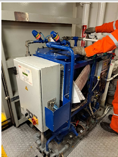
Foto 08: Separador Água-Óleo (SAO)
