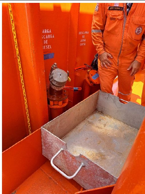
Foto 12: Sistema de abastecimento de diesel
