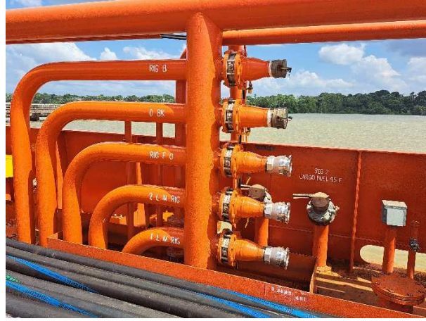
Foto 28: Sistema de abastecimento de diesel para abastecimento da plataforma
