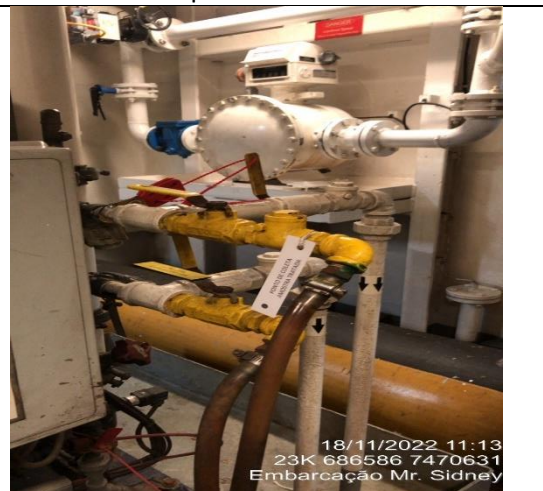
Foto 28: Separador água-óleo – ponto de coleta
