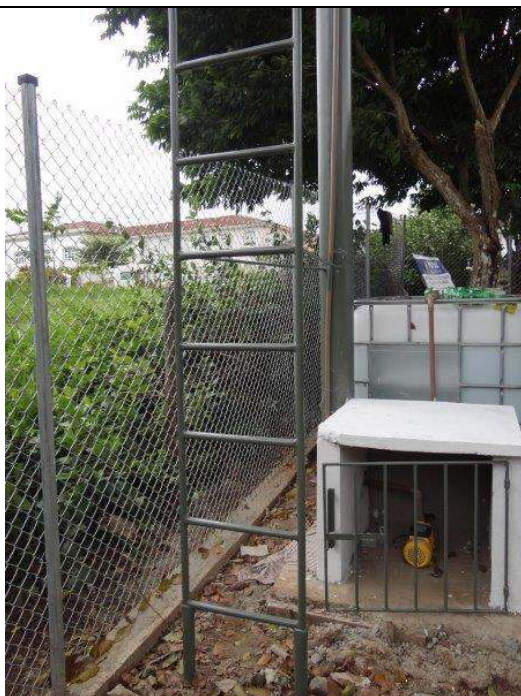
Casa de Bomba.
