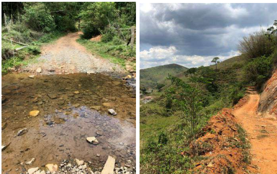
Imagem 18 - Trechos da Estrada que necessitam de intervenção
