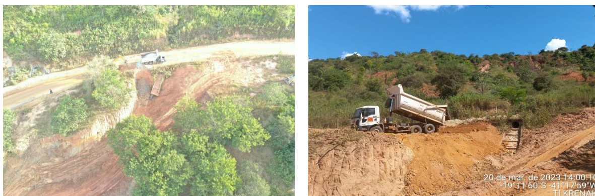
Figura 3 - Foto da erosão provocada pelas intensas chuvas no território indígena.
