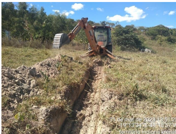
Figura 5 - Extensão de engates para melhor atendimento no abastecimento de água potável
