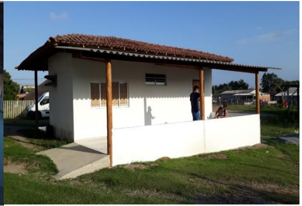
Figura 3.2.2.2-B – Construção de ala para preventivo das mulheres na unidade básica de saúde da aldeia de Caieiras Velha.
