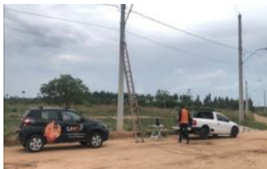
Fotografia 3.1.2.2-4 Instalação Ramal Internet
