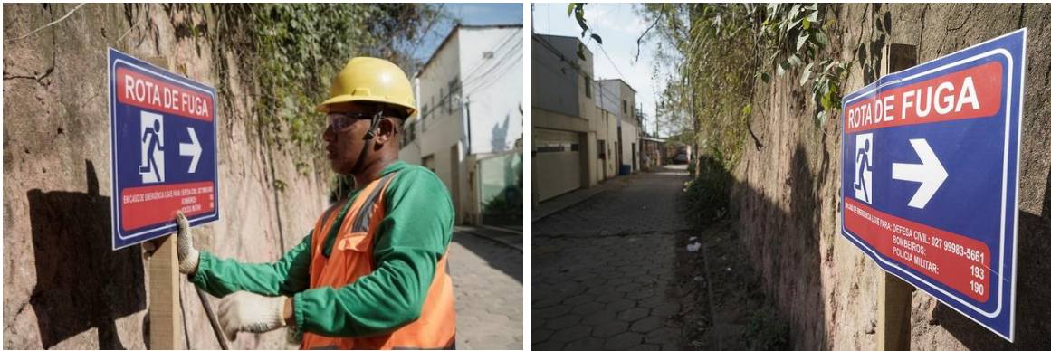
Figura 20: Instalação de rotas de fuga
