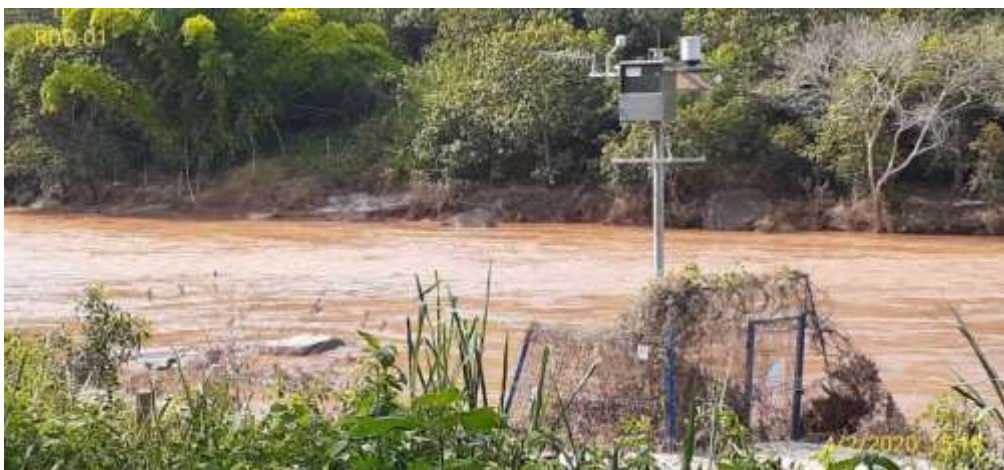
Figura 2 - Estação RDO 01 em 04/02/2020 - detalhe do gradil da PCD danificado.
