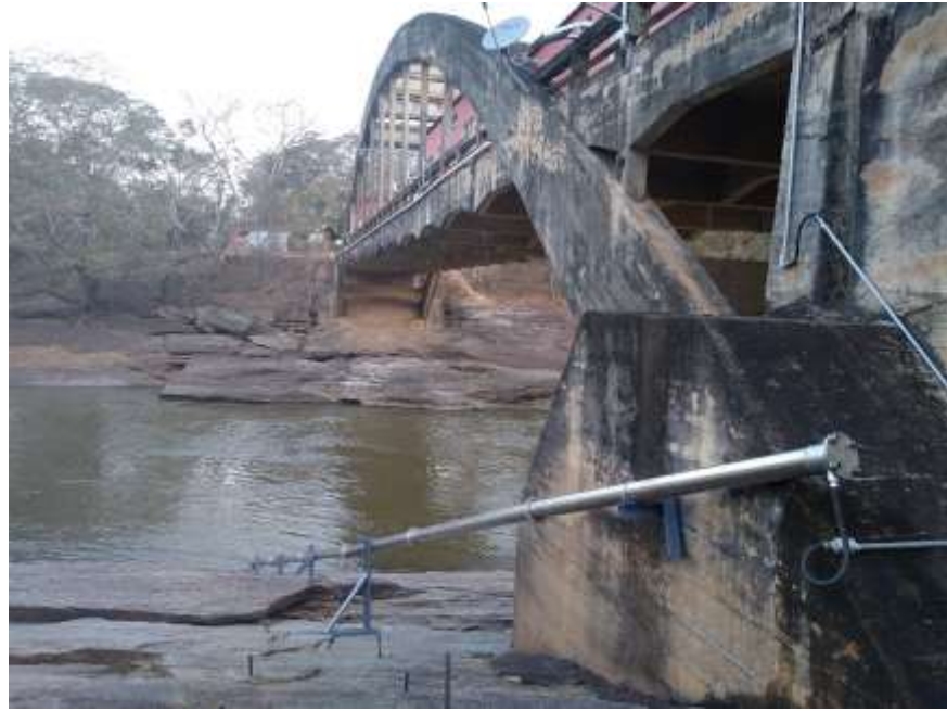
Figura 3 - Tubulação onde está instalada a sonda – 30/09/2020
