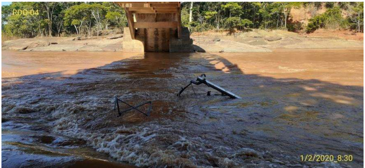
Figura 1 - Píer da estação RDO 04 danificado e submerso – foto de 01/02/2020
