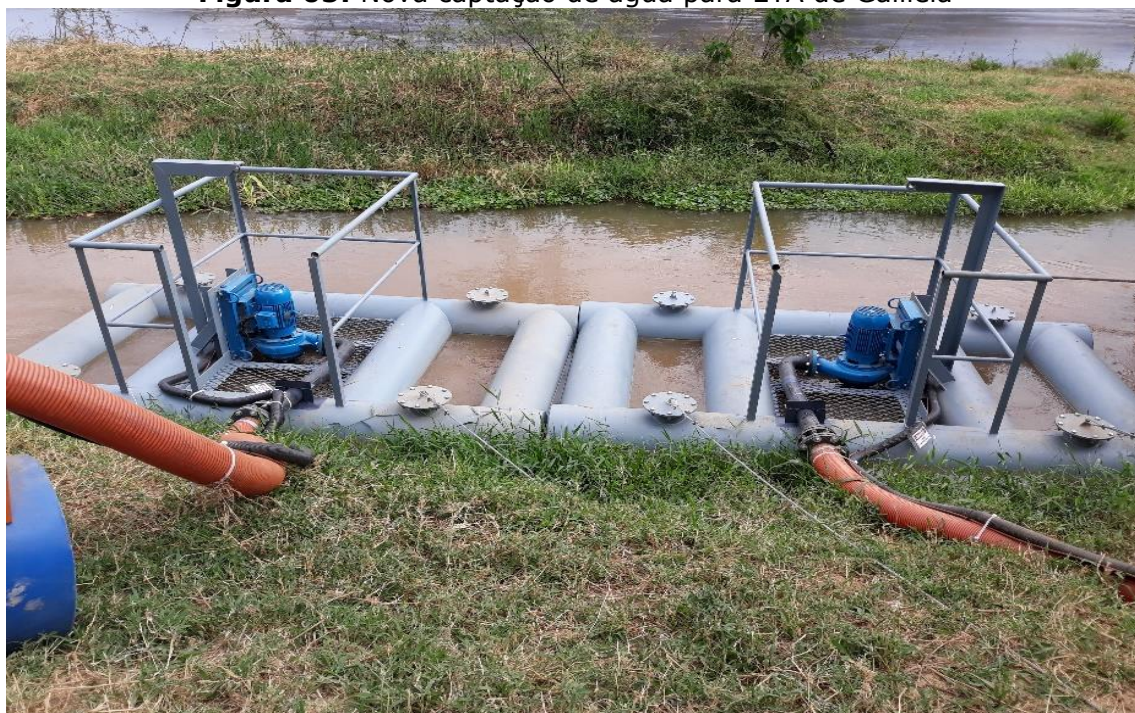
Figura 05: Nova captação de água para ETA de Galileia
