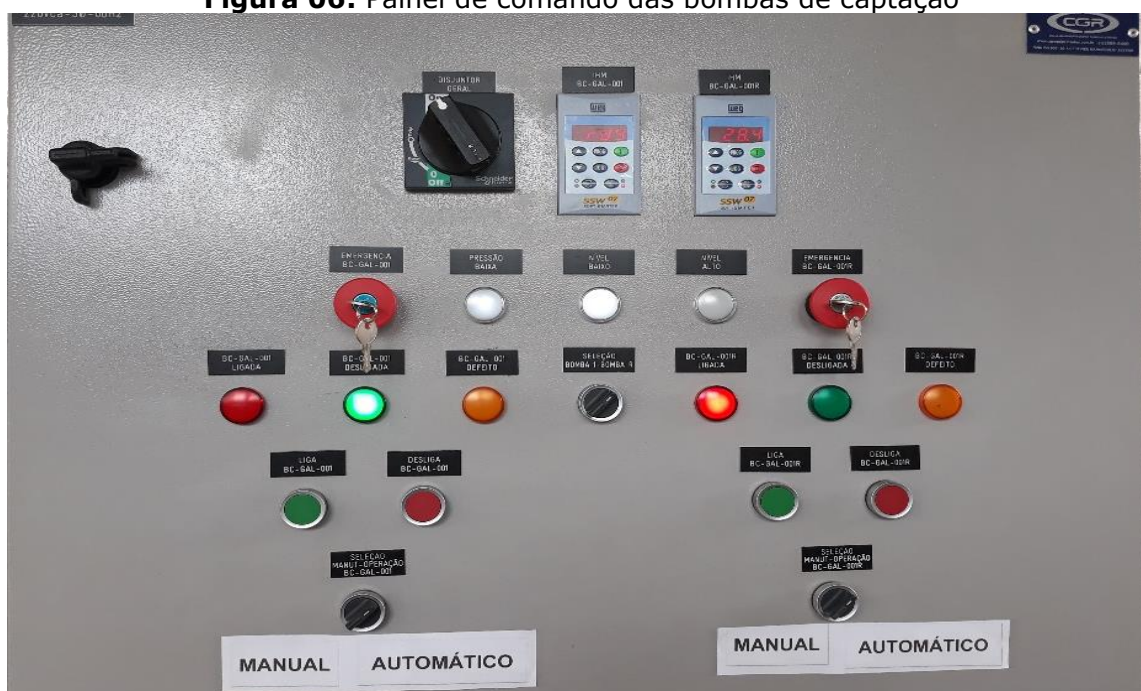
Figura 06: Painel de comando das bombas de captação
