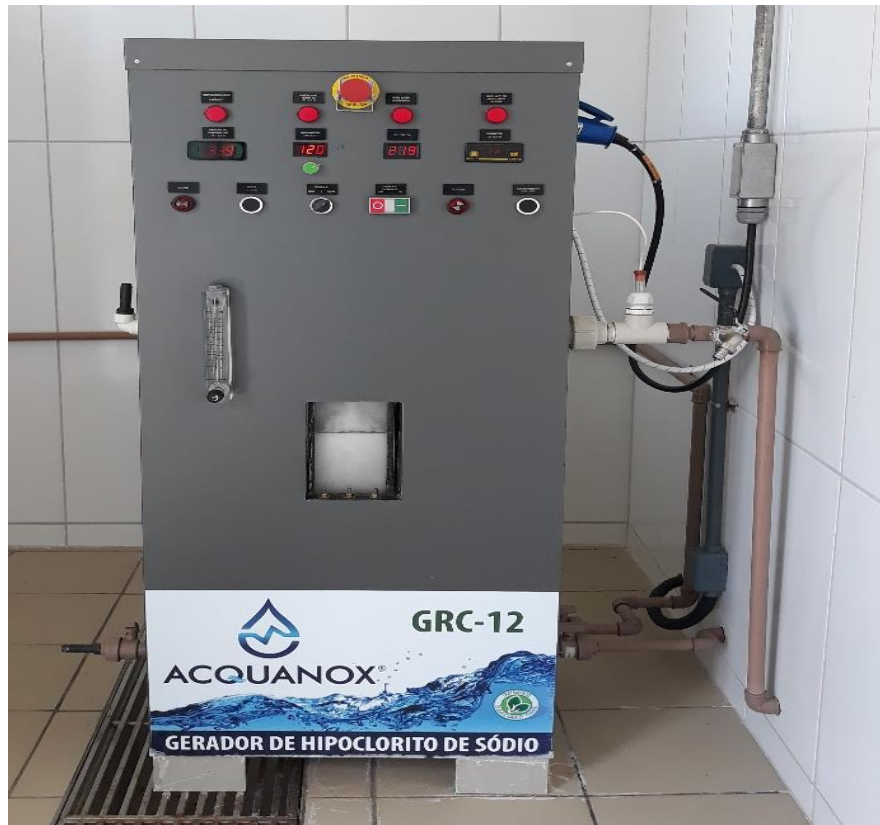
Figura 10: Máquina Geradora de Hipoclorito de Sódio
