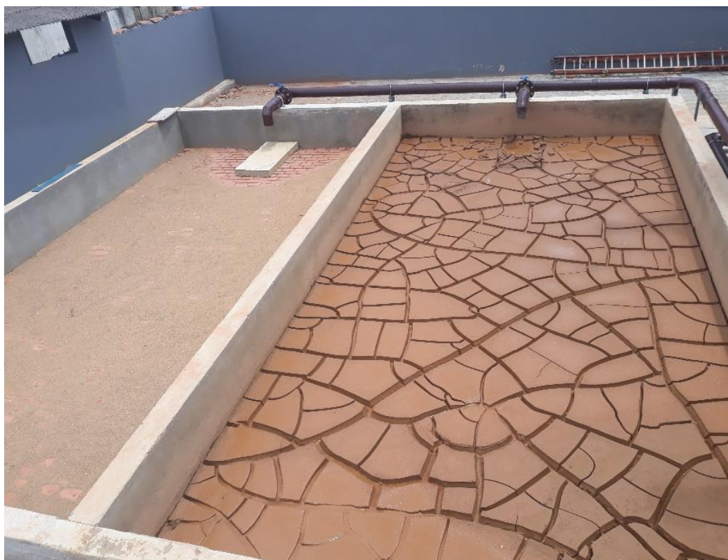
Figura 09: Leito de secagem da UTR
