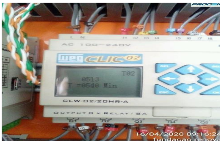
Figura 5 – Painel de operação do Sistema automático
