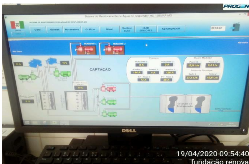
Figura 1 – Painel de monitoramento das bombas e vazão
