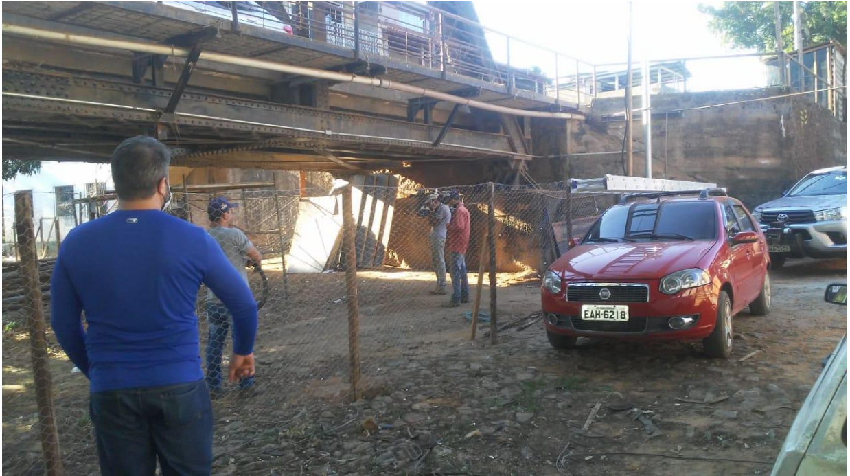
Foto 01: Cercamento devido a obras da prefeitura no ponto de acesso ao RMA-01 – Raul Soares/MG
