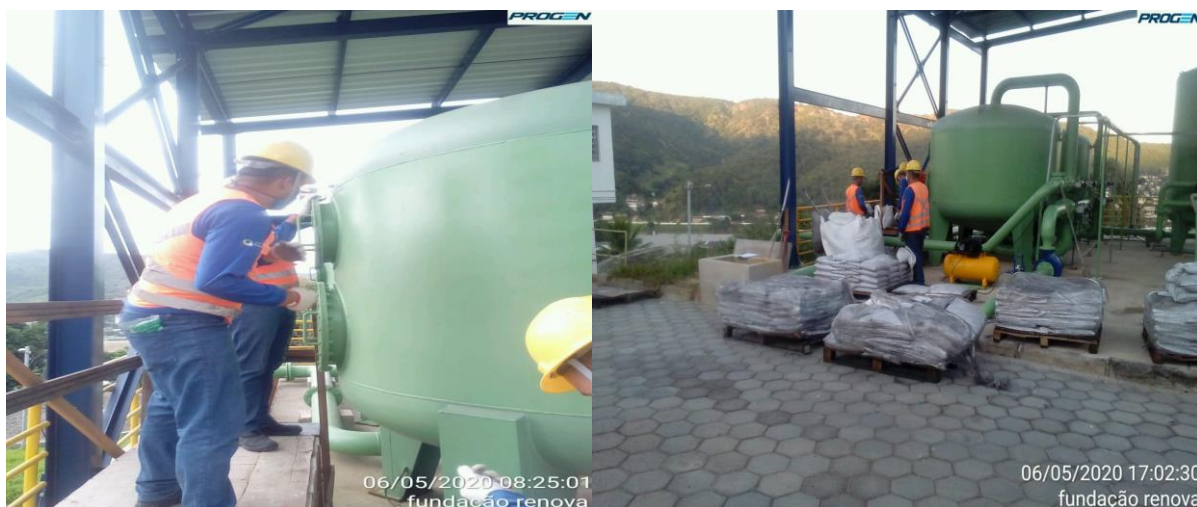
Figura 2 – Troca do material do Filtro STARF
