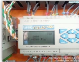
Sistema no automático Ok
