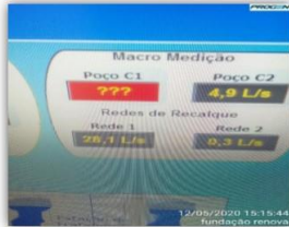
Conferindo a vazão do sistema após a retrolavagem
