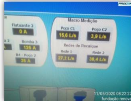
Conferindo a vazão do sistema
