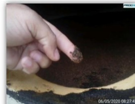
Retirando a janela de visita na parte superior do filtro e conferindo a areia zeólita
