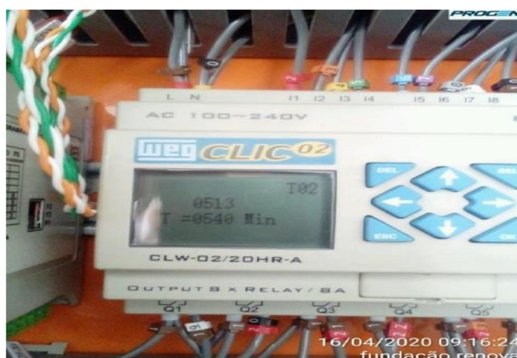
Figura 5 – Painel de operação do Sistema automático
