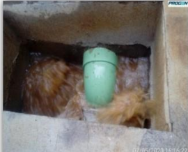
Iniciando o a retrolavagem do filtro STARF
