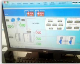
Sistema no automático Ok
