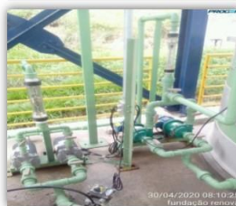
Conferindo às válvulas da regeneração
