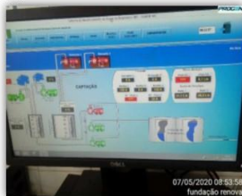
Sistema automático com uma vazão de 31 l/s
