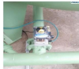
Finalizando o ciclo todo no sistema automático
