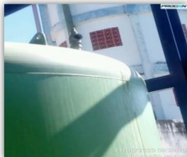
Válvula de segurança com vazamento no filtro STARF
