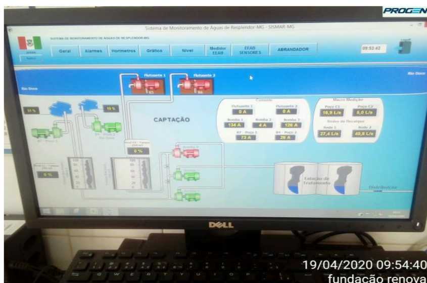
Figura 1 – Painel de monitoramento das bombas e vazão
