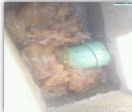
Retrolavagem do filtro STARF
