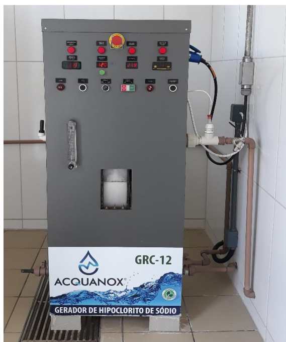
Máquina Geradora de Hipoclorito de Sódio
