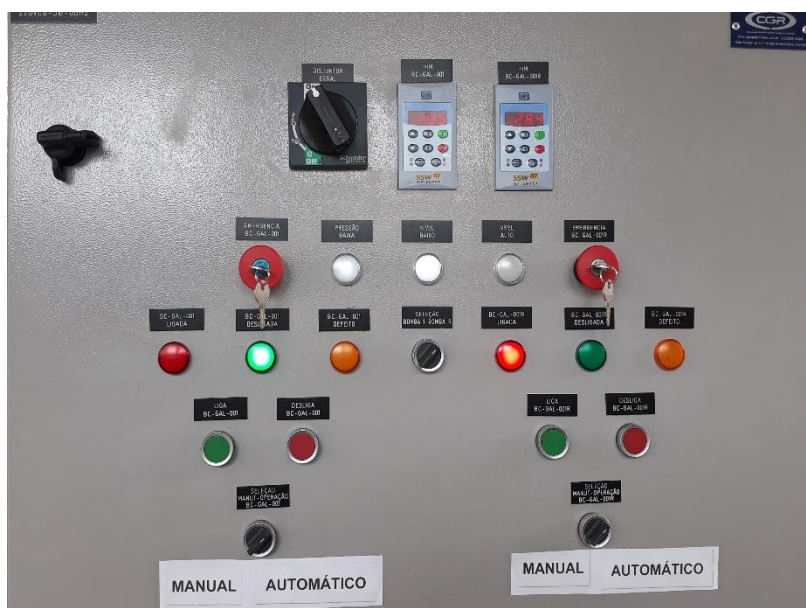
Painel de comando das bombas de captação
