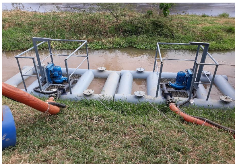
Nova captação de água para ETA de Galileia
