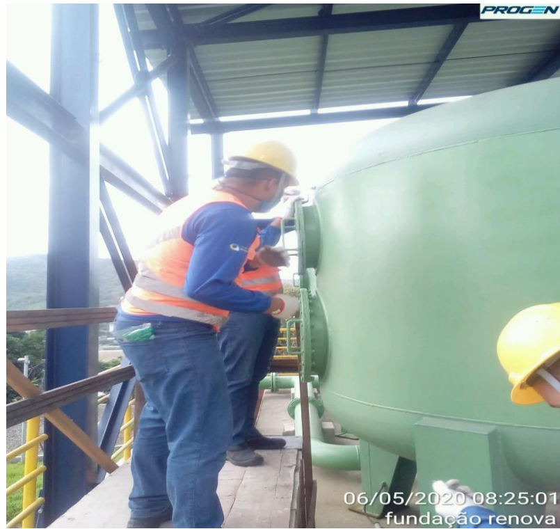
Figura 2 – Troca do material do Filtro STARF
