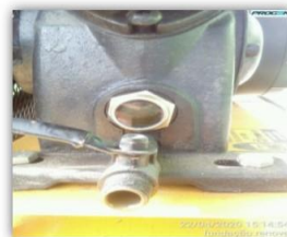
Óleo do compressor trocado
