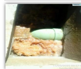
Executando a retrolavagem depois de 8 horas de campanha.
