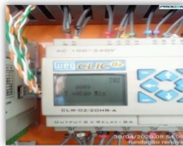
Sistema no automático Ok
