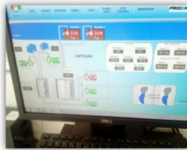
Sistema no automático Ok
