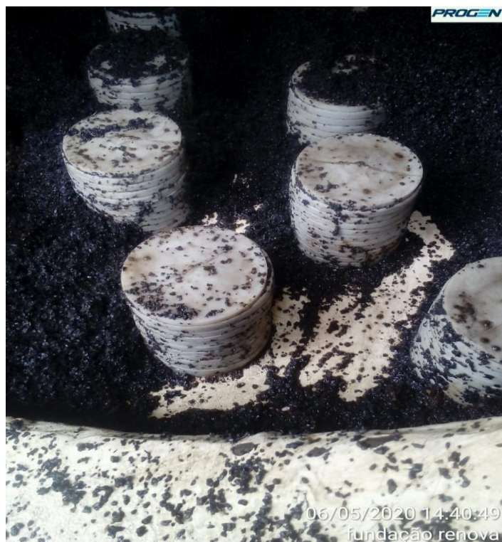
Figura 5 – Troca do material do Filtro STARF
