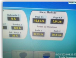
Conferindo a vazão do sistema
