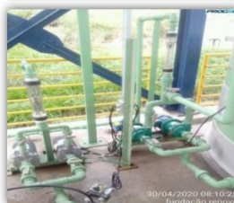
Conferindo às válvulas da regeneração
