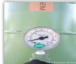
Acompanhamento da pressão do filtro STARF
