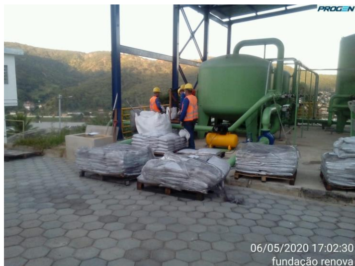
Figura 4 – Troca do material do Filtro STARF
