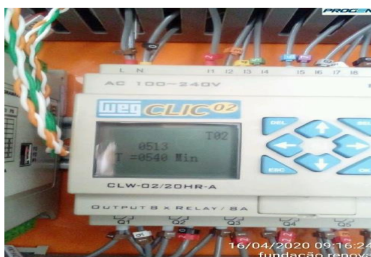
Figura 8 – Painel de operação do Sistema automático
