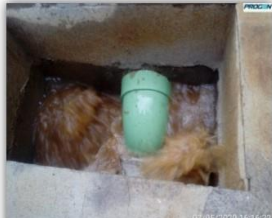
Iniciando o a retrolavagem do filtro STARF
