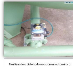
Finalizando o ciclo todo no sistema automático
