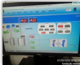
Sistema automático com uma vazão de 31 l/s
