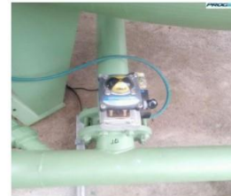
Finalizando o ciclo todo no sistema automático
