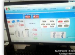
Conferindo se as bombas do Poço C1, C2 e bomba nº3 estão desligadas
