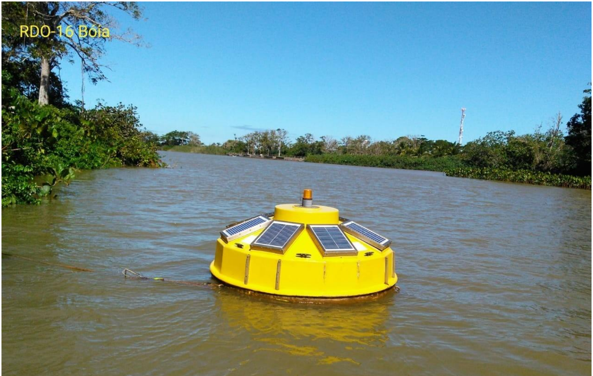
Figura 3 - Vista de montante para jusante da boia posicionada no local determinado, onde é possível ver o porto de Regência ao Fundo, ponto de referência para localização do equipamento.
