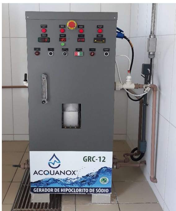
Máquina Geradora de Hipoclorito de Sódio
