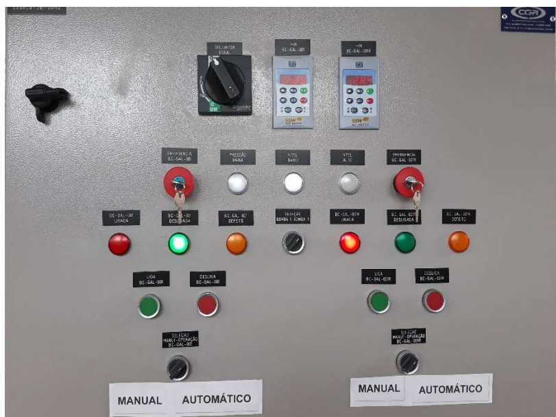
Painel de comando das bombas de captação
