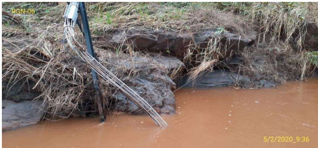
Figura 3 - Tubo de proteção do turbidímetro danificado na RGN 06 em 05/02/20.
