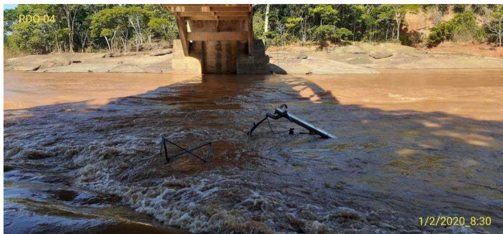
Figura 16 - Pier da estação RDO 04 danificado e submerso – foto de 01/02/2020.
