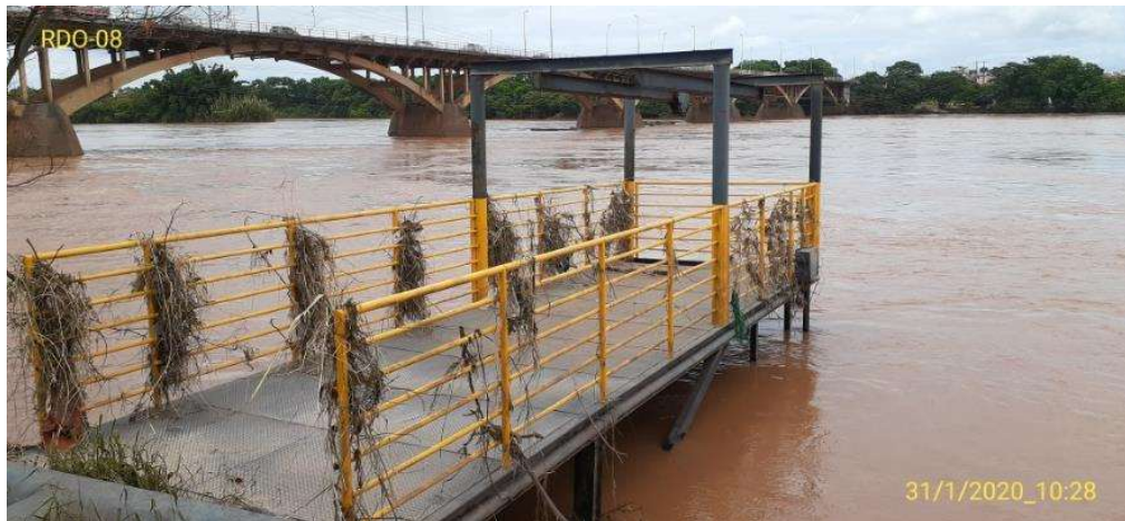
Figura 21 - Pier da ETA Vila Isa em Gov. Valadares/MG, atingido pelo cheia, mas sem danos estruturais.
