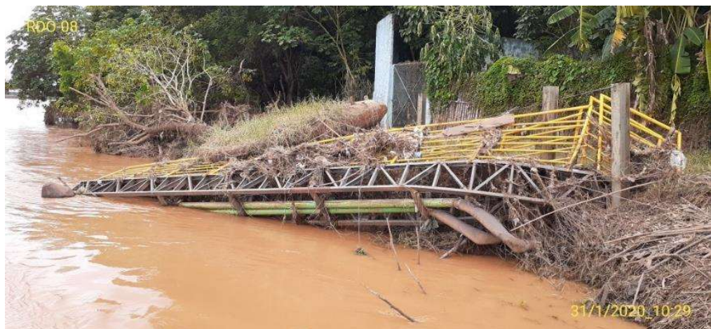
Figura 20 - Pier danificado da RDO 08 em 31/01/2020.
