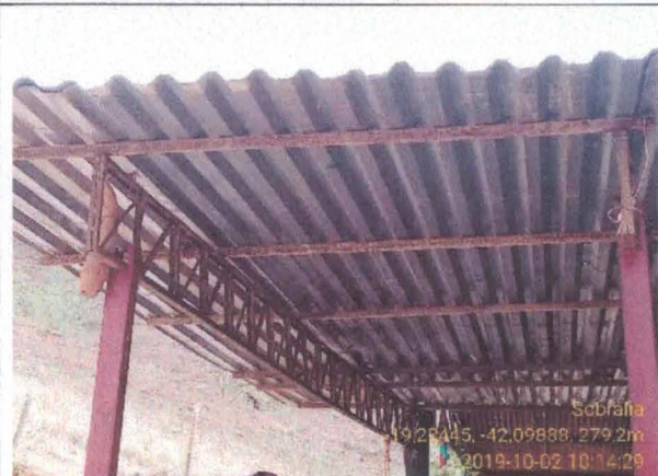
36. Detalhe da cobertura em processo de ferrugem (02/10/19)
