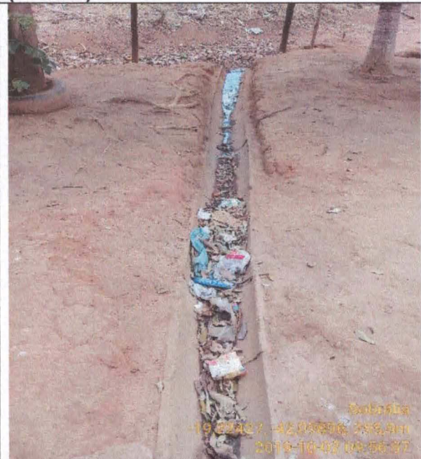
16. Canaleta de drenagem pluvial - obstruída (02/10/19)
