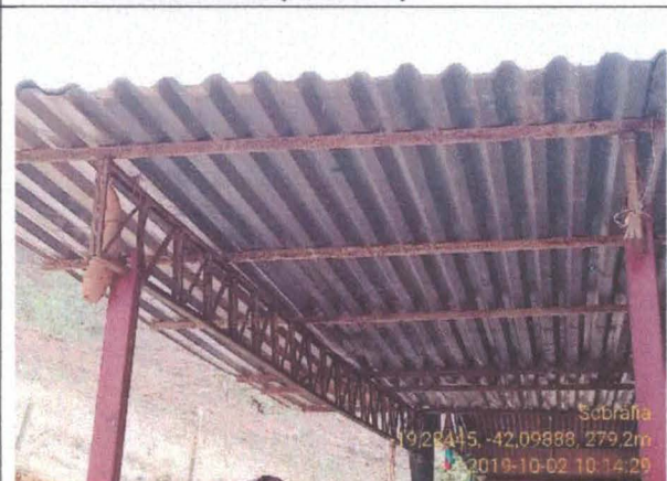
36. Detalhe da cobertura em processo de ferrugem (02/10/19)
