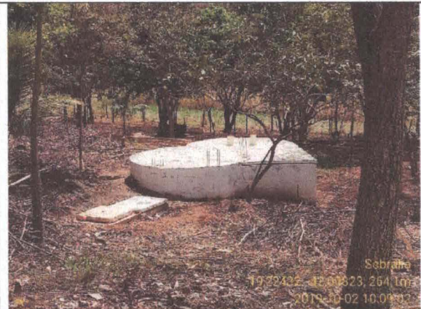
26. Sistema de tratamento do esgoto doméstico (02/10/19)
