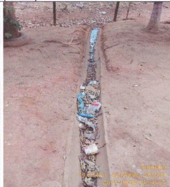
16. Canaleta de drenagem pluvial - obstruída (02/10/19)
