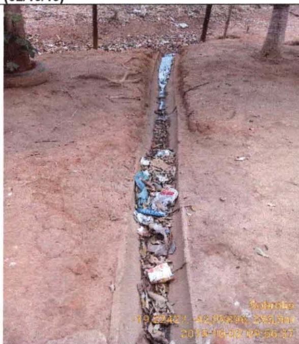
16. Canaleta de drenagem pluvial - obstruída (02/10/19)
