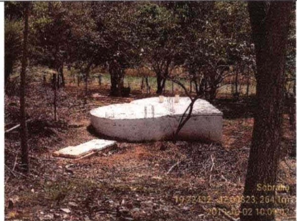
26. Sistema de tratamento do esgoto doméstico (02/10/19)
