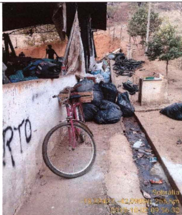
14. Canaleta de drenagem pluvial - obstruída (02/10/19)
