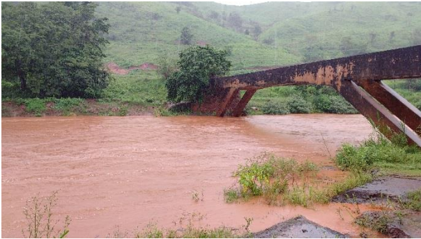
Figura 4.3: Condição do fluxo no rio do Carmo próximo a confluência com o rio Piranga durante a investigação de dezembro de 2016.
