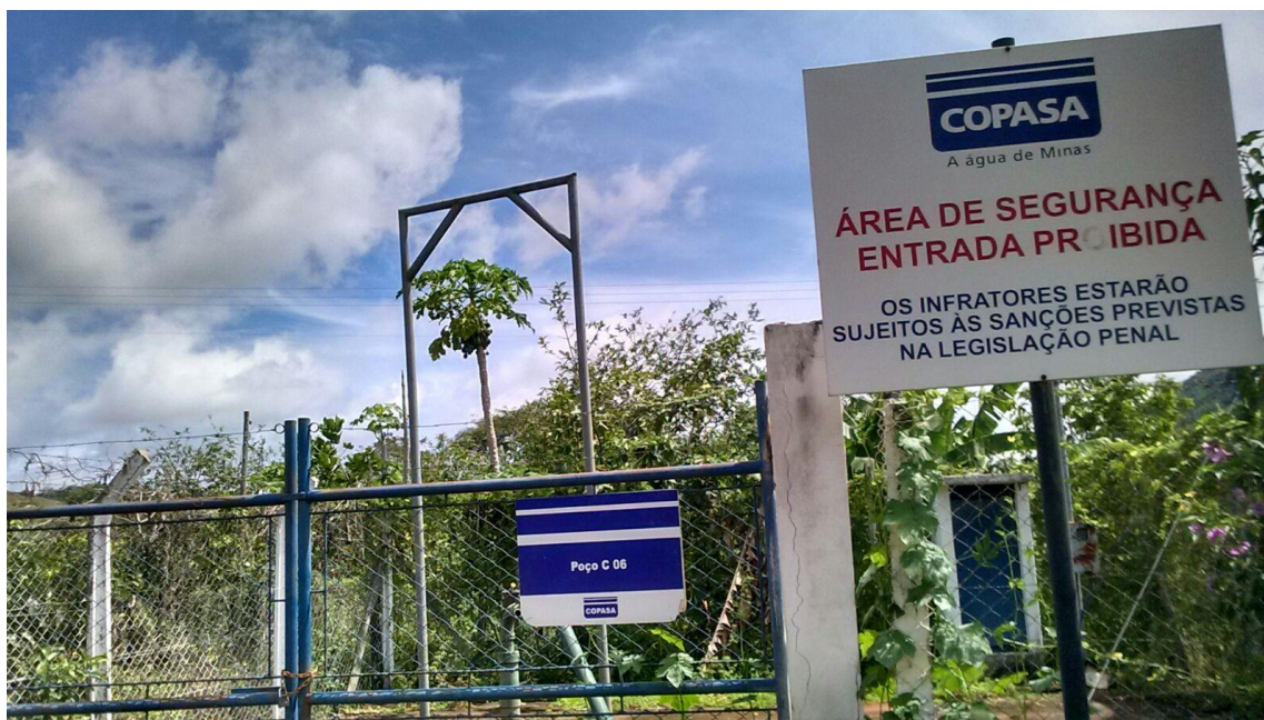
Figura 31: Ponto de captação de água para abastecimento público no Poço Artesiano (Poço C06)(Coordenadas: S19°14'38.18'' W42°06'14.64'')
