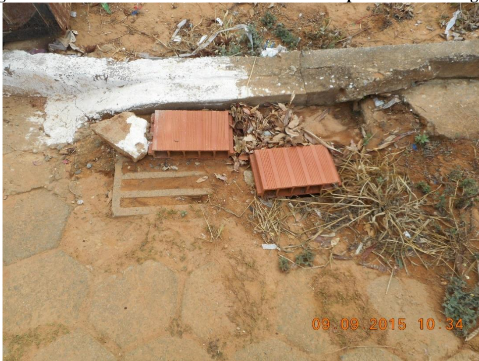
Figura 55: Resultado do carreamento de sedimentos para a rede drenagem
