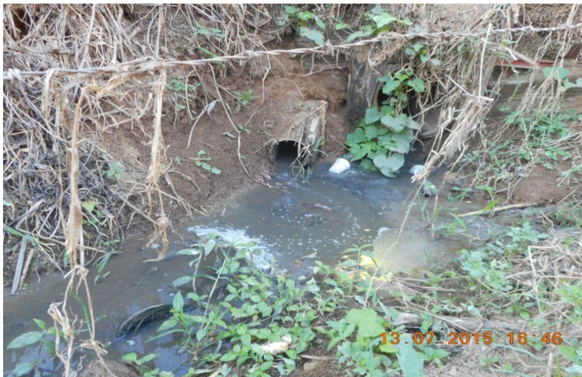
Figura 42: Ponto de lançamento de esgoto doméstico in natura na sede de Sobrália (Coordenadas: S 19°14'2,54" W 42° 5'48,49")
