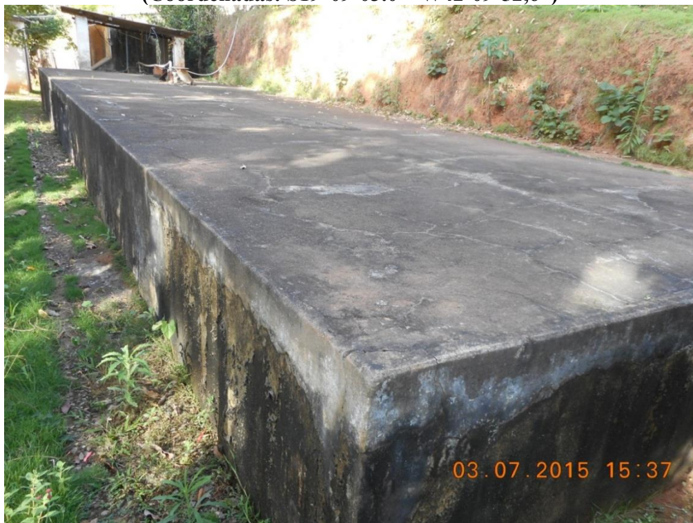
Figura 38: Reservatório para armazenamento no Distrito Plautino Soares (Coordenadas: S19°09'03.0" W42°09'52,6")
