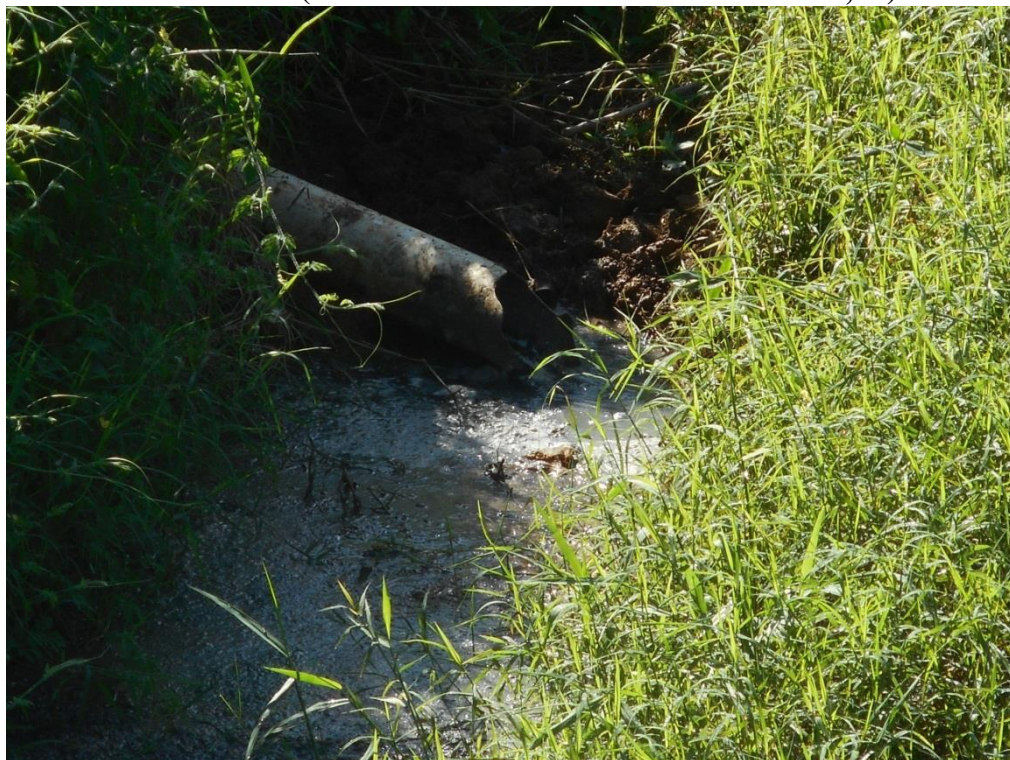
Figura 65: Ponto de lançamento de esgoto doméstico in natura da rede coletora na sede de Sobrália (Coordenadas: S 19°13'59" W 42° 05'57,6")
