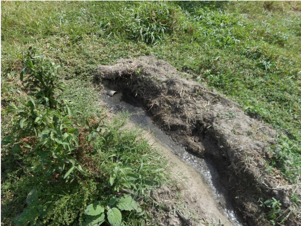
Figura 70: Esgoto ao céu aberto – Setor 05 (Coordenadas: S19°13'25,8" - W42°08'43,4")
