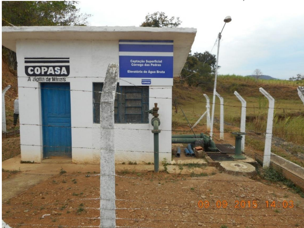
Figura 53: Estação elevatória do SAA da sede de Sobralia (Coordenadas: S 19°14'22.8" W 42°05'39.3")
