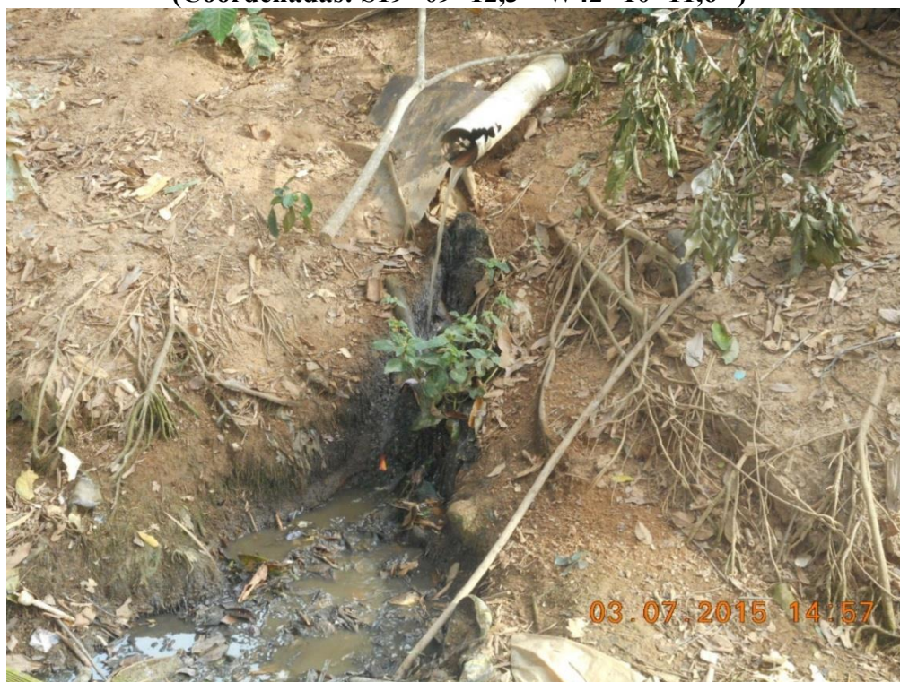
Figura 67: Lançamento de esgoto doméstico in natura no Distrito de Plautino Soares (Coordenadas: S19° 09' 12,3'' W42° 10' 11,6'')
