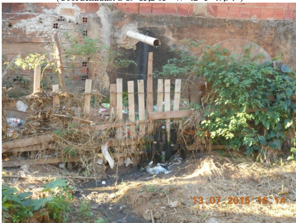
Figura 63: Ponto de lançamento de esgoto doméstico in natura na sede de Sobrália (Coordenadas: S 19°15,2'03" W 42° 5' 47,94")
