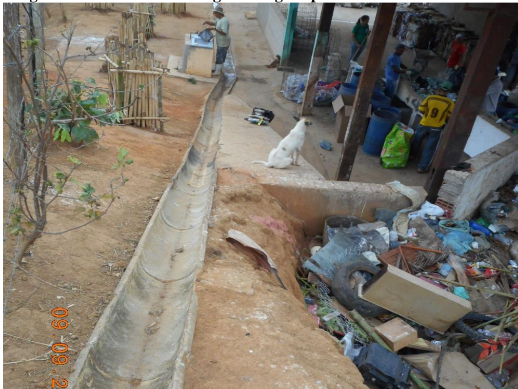
Figura 80: Sistema de drenagem de águas pluviais construído na UTC.
