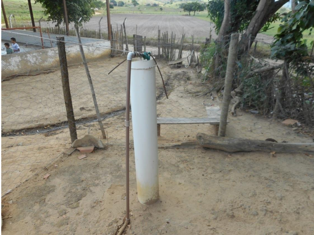
Figura 57: Poço artesiano para captação de Água (Coordenadas: S19°17'27.0" W42°08'48,5")
