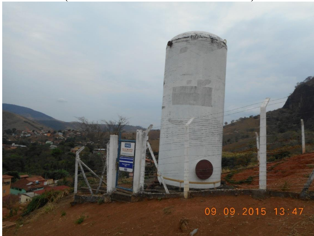
Figura 52: Reservatório REL 02 (Coordenadas: S 19°14'24.2" W 42°05'37.4")
