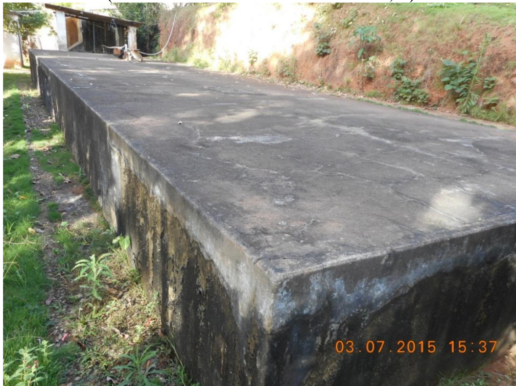
Figura 56: Reservatório para armazenamento no Distrito Plautino Soares (Coordenadas: S19°09'03.0" W42°09'52,6")
