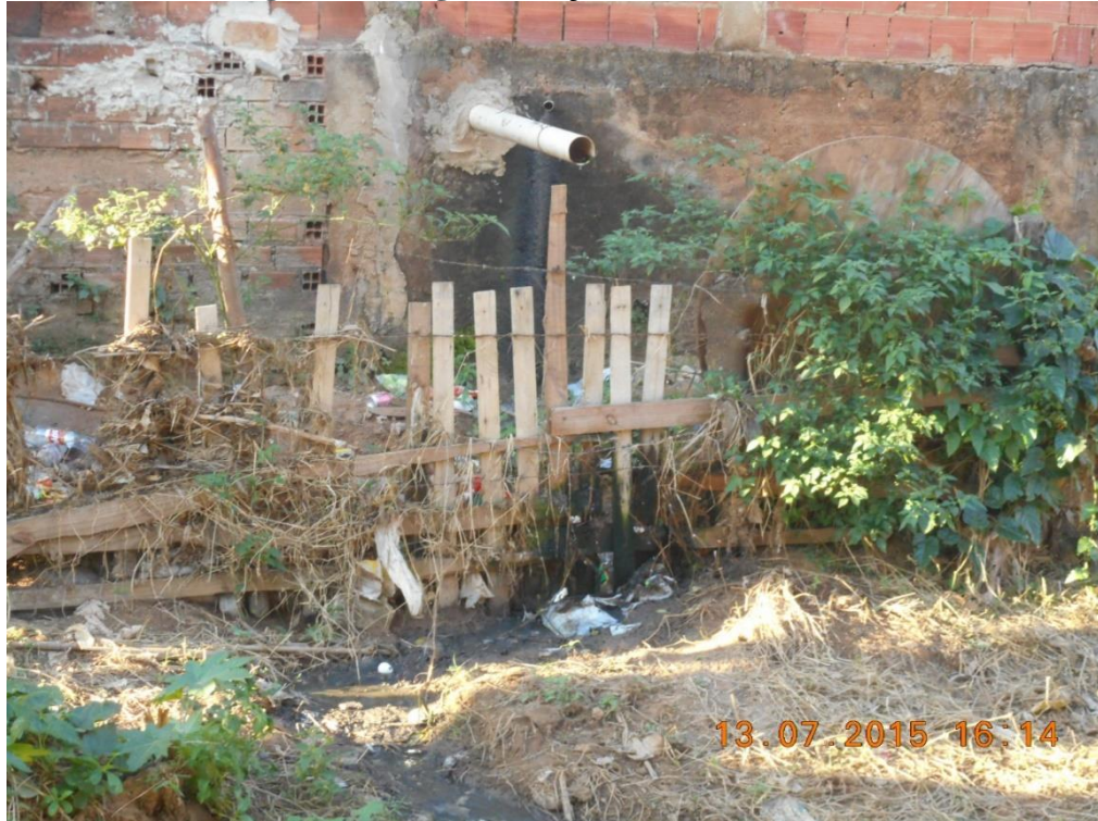
Figura 99: Esgoto Lançado na Rede Fluvial
