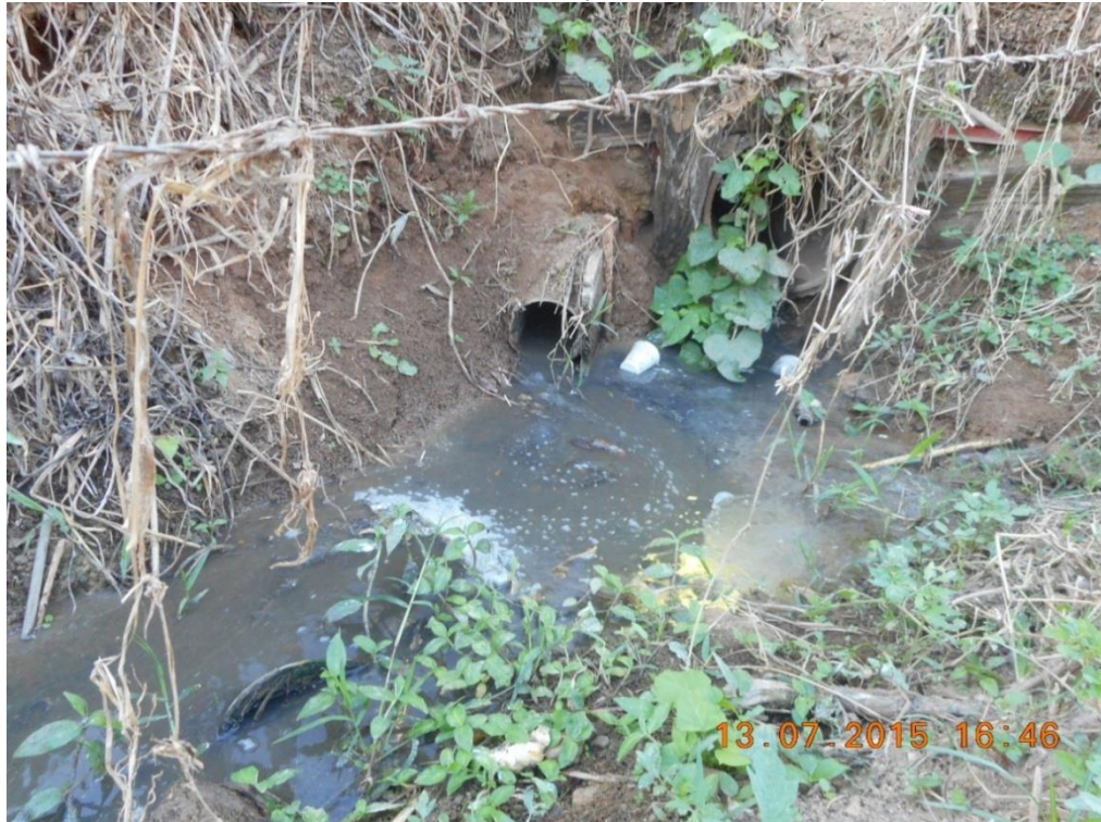
Figura 64: Ponto de lançamento de esgoto doméstico in natura na sede de Sobrália (Coordenadas: S 19°14'2,54" W 42° 5'48,49")
