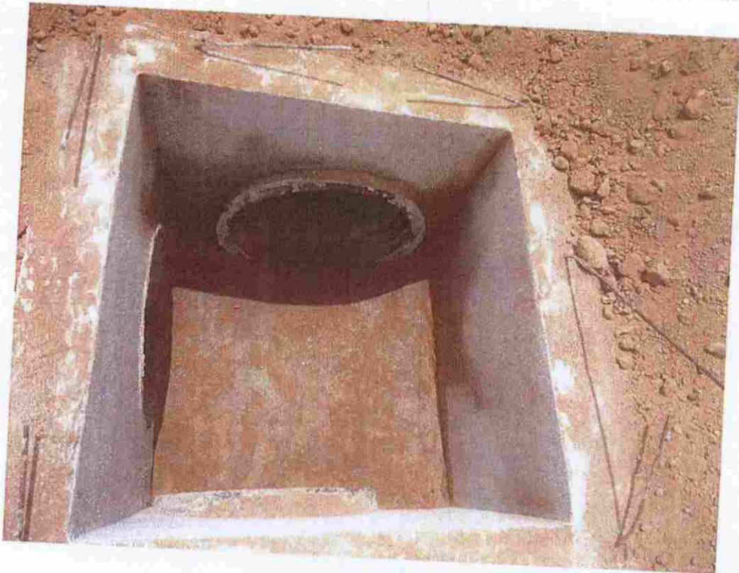
FOTO 21 – Caixa de interligação próxima ao leito de secagem
