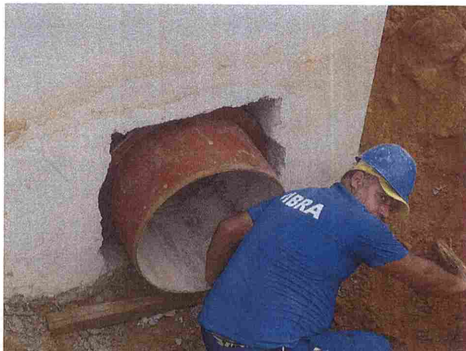
FOTO 4 – Vista da entrada na CF1 da tubulação de interligação do sistema Ø600 mm.
