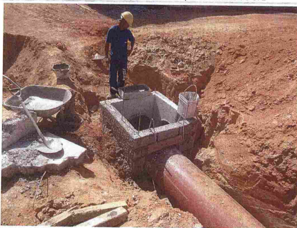
FOTO 16 – Vista do PV do sistema de interligação após a CF2
