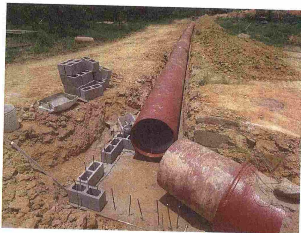
FOTO 19 – Assentamento da tubulação Ø450 mm de interligação do sistema, próximo ao leito de secagem.
