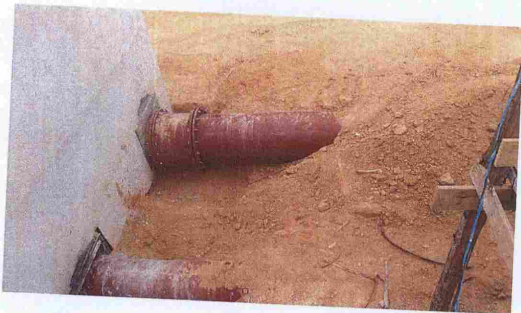
FOTO 22 – Saída da CF2 da tubulação Ø450 mm de interligação do sistema.
