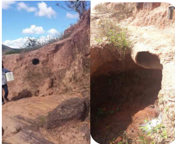
Adutora do Córrego Santaninha da COPASA.
