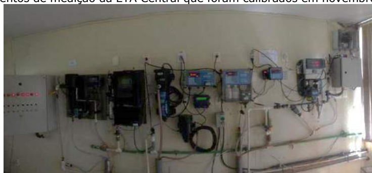
Equipamentos de medição da ETA Central que foram calibrados em novembro de 2016.
