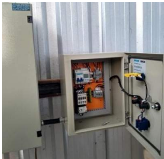
Painel de acionamento da bomba
