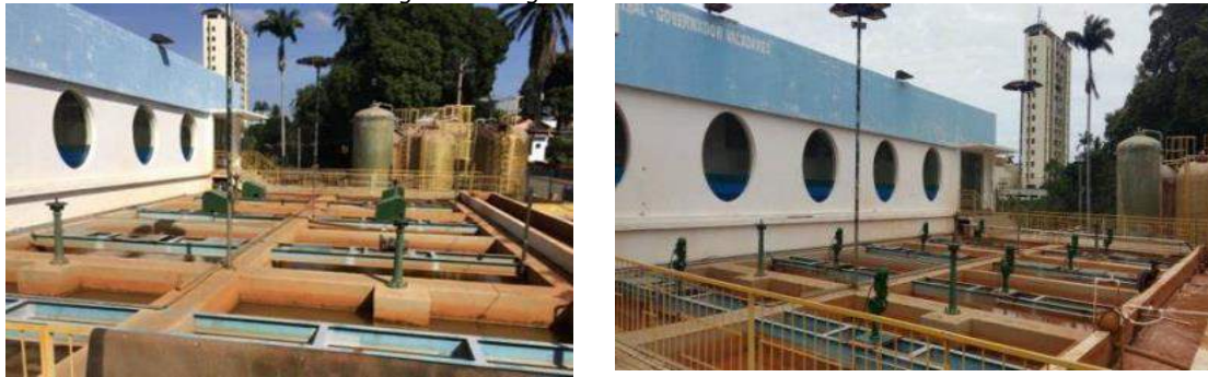
Imagens dos agitadores instalados na ETA Central.
