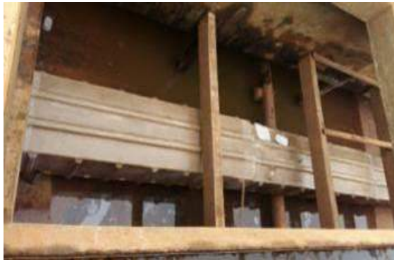
Difusor instalado em decantador da ETA Central.
