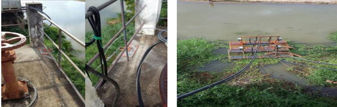
Novo sistema de ancoragem e alimentação elétrica da Balsa de captação da ETA II
