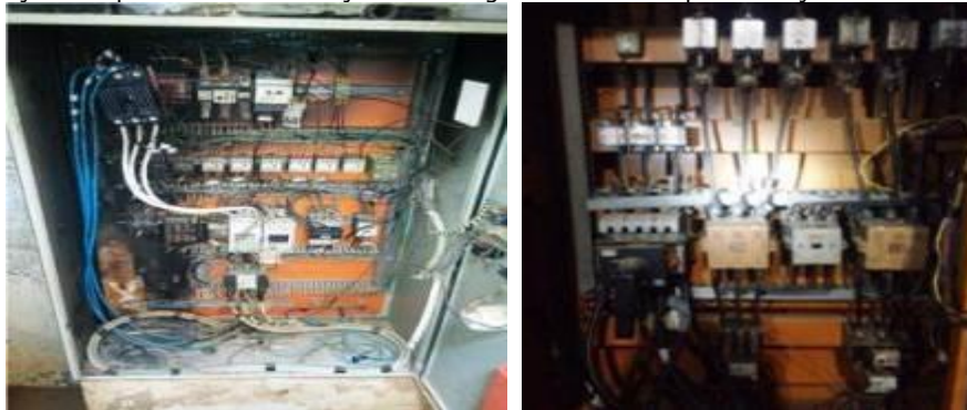
Situação dos painéis de distribuição de voltagem antes da implementação de melhorias.
