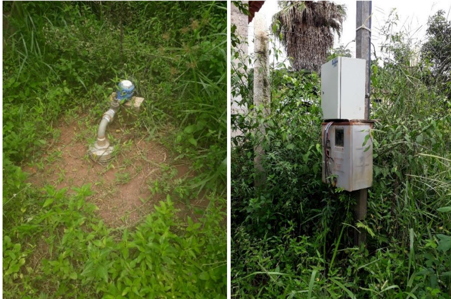
Poço tubular da localidade (à esquerda) e painel de comando do poço (à direita)
