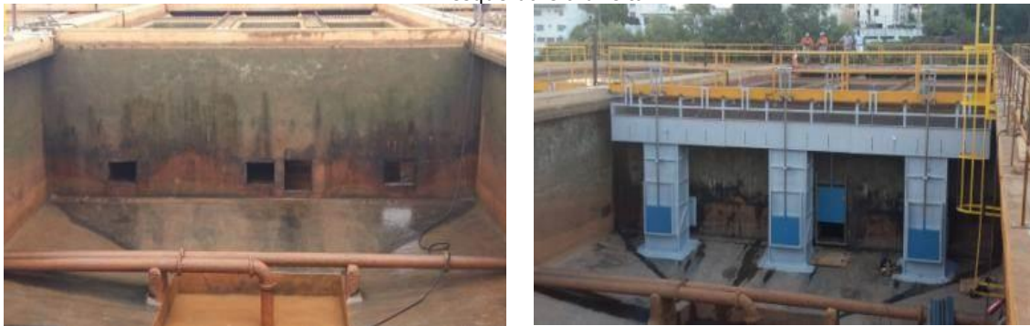
Melhoria da decantação pela instalação de calhas de overflow , cenário de antes e depois, respectivamente à esquerda e à direita.
