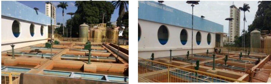
Imagens dos agitadores instalados na ETA Central.
