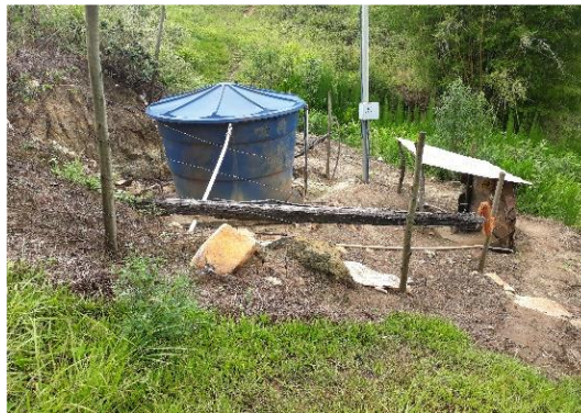
Reservatório intermediário e bomba de recalque atualmente instalados no distrito de Pedras
