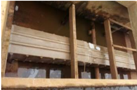
Difusor instalado em decantador da ETA Central.
