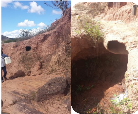
Adutora do Córrego Santaninha da COPASA.
