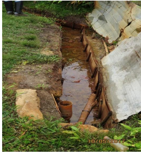
Captação em nascente para abastecimento do distrito de Pedras
