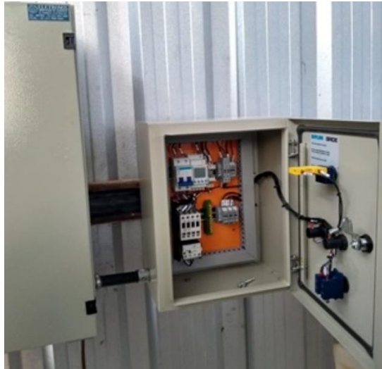
Painel de acionamento da bomba
