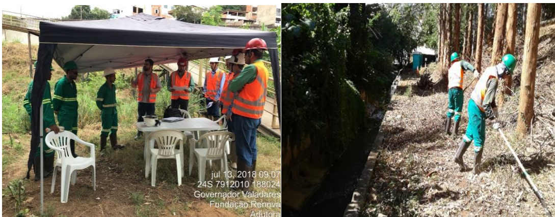
Início da supressão vegetal para realização da obra da adutora de Governador Valadares
