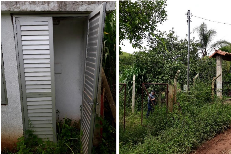
Estrutura construída no local do poço encontra-se danificada e sem uso (à esquerda) e Entrada do local onde está localizado o poço tubular (à direita)
