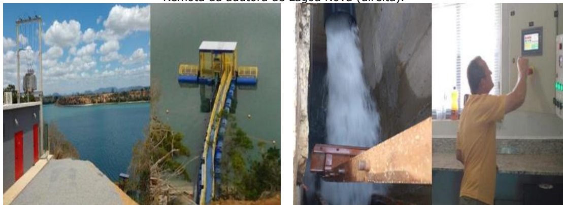
Sistema de Bombeamento e Subestação (esquerda) e Chegada de água no SAAE e painel de operação Remota da adutora de Lagoa Nova (direita).
