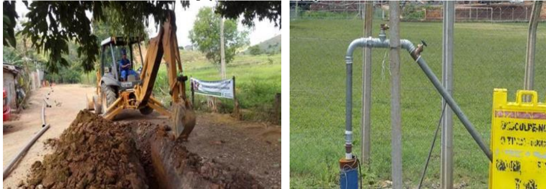
Evidências da interligação hidráulica do poço tubular PN01 à adutora.
