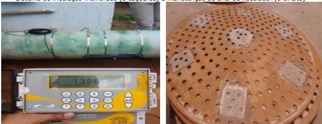
Sistema de medição melhorado (à esquerda) e manutenção de anel de floculador (à direita)
