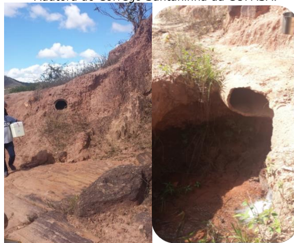
Adutora do Córrego Santaninha da COPASA.
