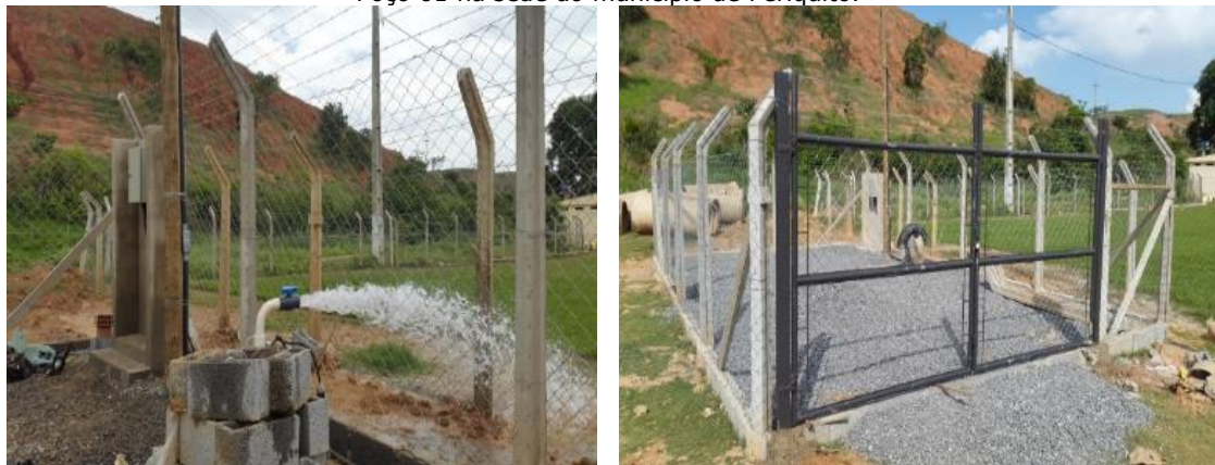
Poço 01 na sede do município de Periquito.
