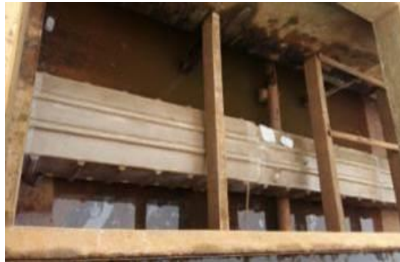
Difusor instalado em decantador da ETA Central.
