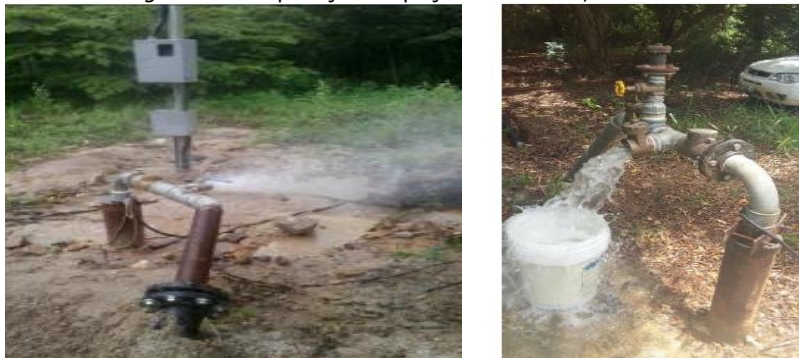
Imagem de recuperação de poço da COPASA, em Itueta.
