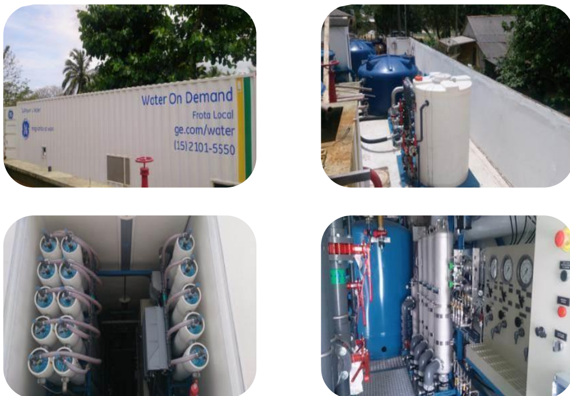
Figura 63: Imagens da Estação de Tratamento Móvel.
