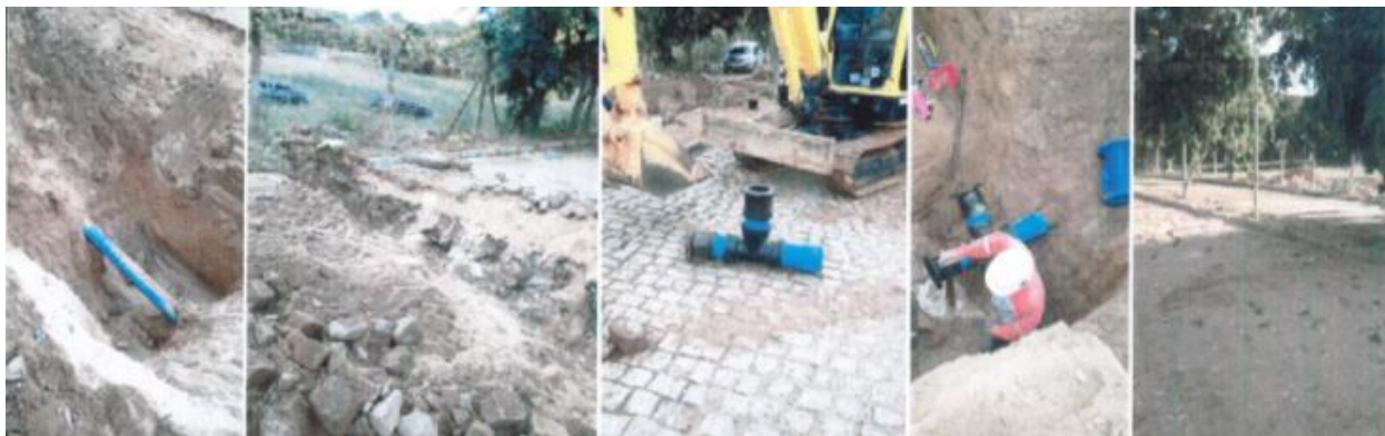
Figura 96: Poço de Aimorés, com vazão aproximada de 8,57 L/s, interligado na adutora de captação do Rio Doce.
