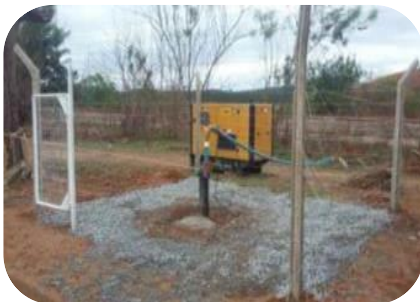
Figura 72: Poço 03 de Belo Oriente, considerado para abastecimento emergencial.
