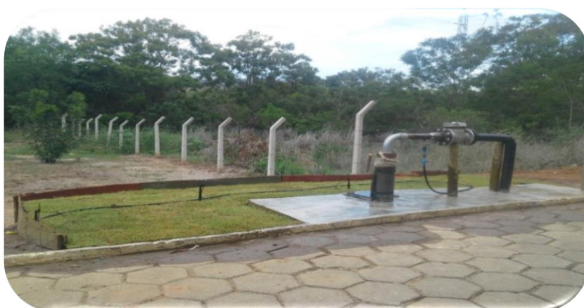
Figura 97. Imagem do poço de Mascarenhas interligado a ETA do distrito.
