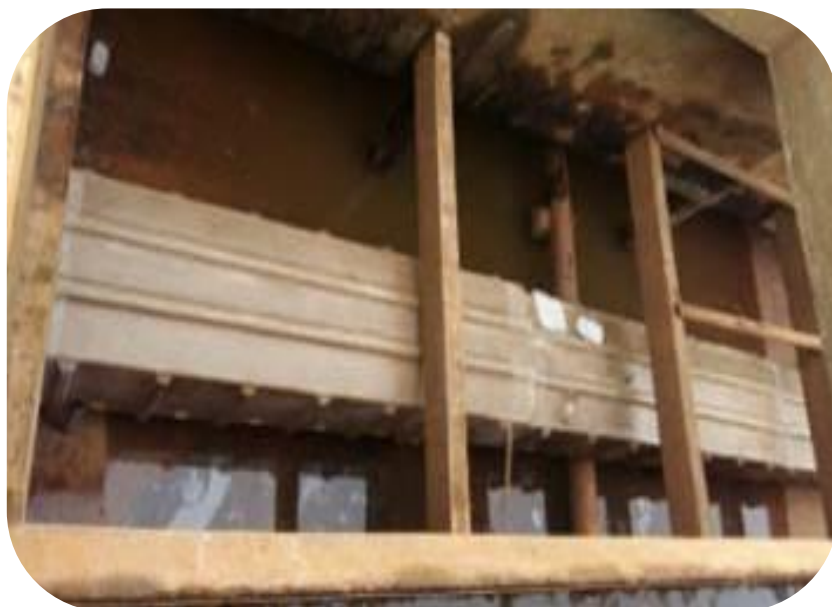
Figura 14: Difusor instalado em decantador da ETA Central.
