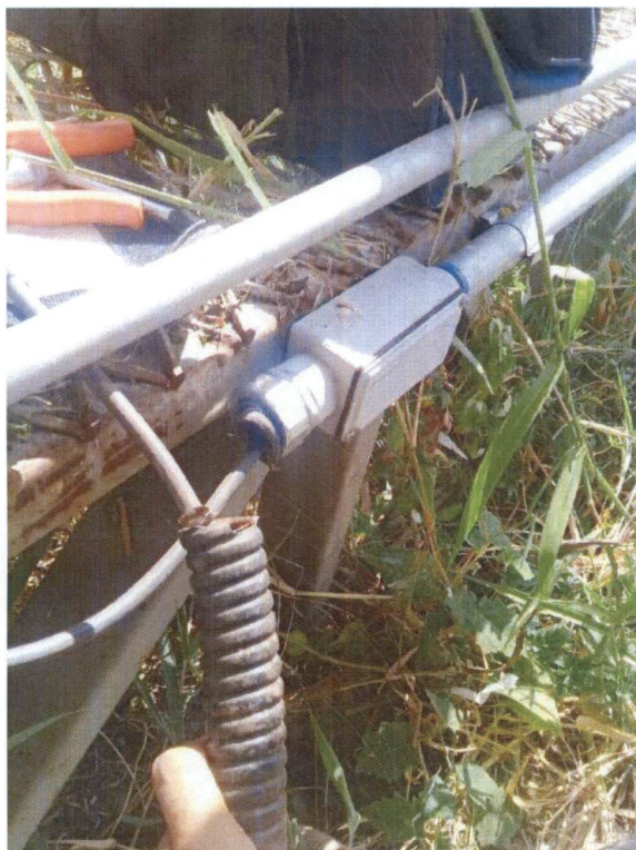
Foto 02: Conduíte de proteção do cabo danificado.
