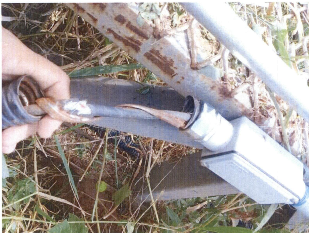
Foto 01: Evidencia do cabo de alimentação e comunicação da sonda danificado.
