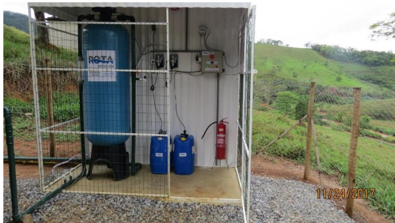
Gesteira: Sistema de tratamento de água completo: Filtro, pintura da tubulação, bombonas com produtos químicos, bombas dosadoras, quadro de comando etc.
