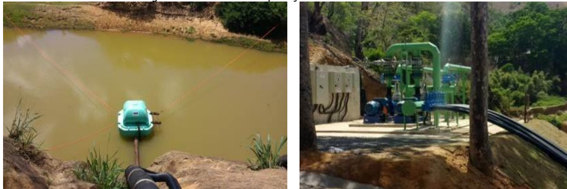
Imagens do sistema de operação da adutora Santa Maria
