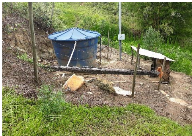
Reservatório intermediário e bomba de recalque atualmente instalados no distrito de Pedras
