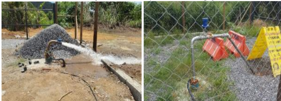
Evidência da localização do PN02 à esquerda e da interligação à direita
