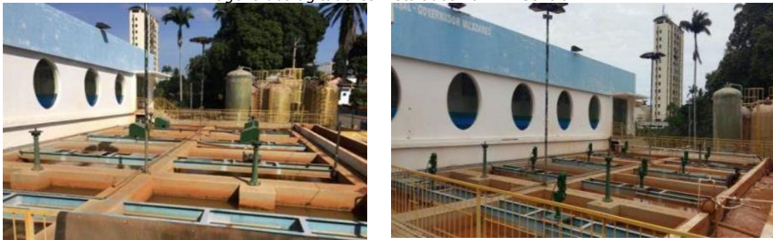
Imagens dos agitadores instalados na ETA Central.
