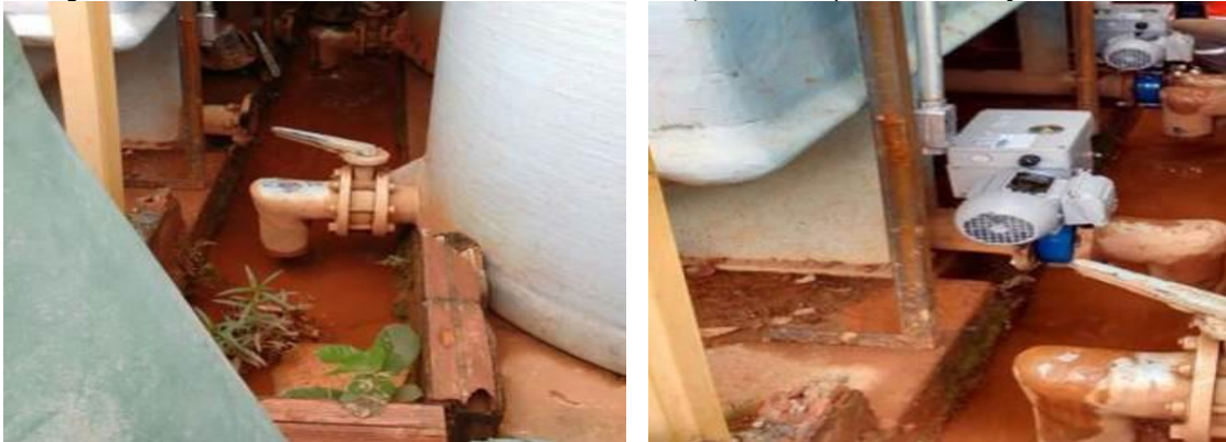
Imagem dos drenos dos decantadores da ETA Santa Rita, antes e depois da instalação das válvulas.
