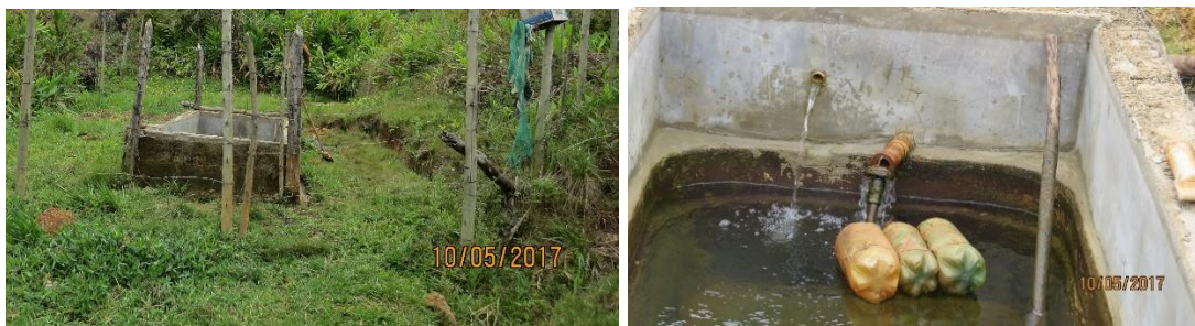
Caixa de areia utilizada após a captação por nascente (à esquerda) e Detalhes de adaptações no sistema de bóias da caixa de areia (à direita)
