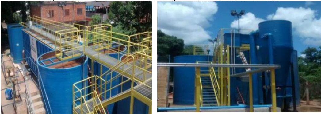
Imagens da Estação de Tratamento de Água Modular de Cachoeira Escura
