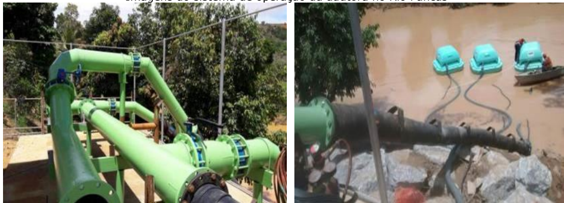
Imagens do sistema de operação da adutora no Rio Pancas
