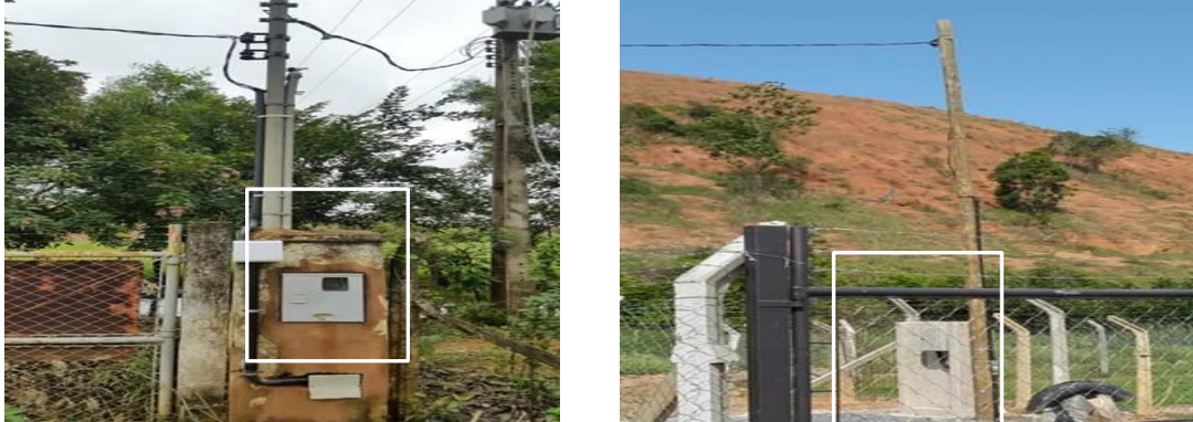
Evidências de painéis elétricos instalados no Poço PN01.
