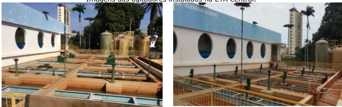
Imagens dos agitadores instalados na ETA Central.
