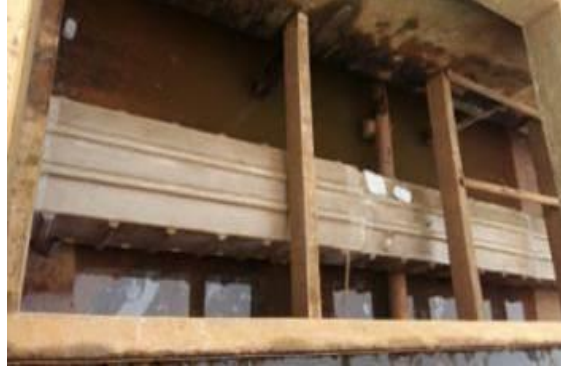
Difusor instalado em decantador da ETA Central.
