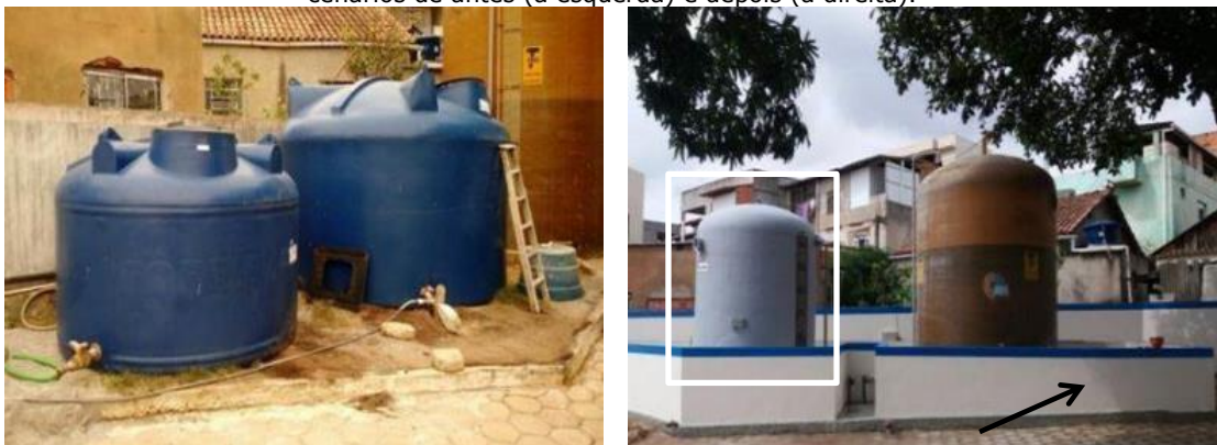
Construção de caixa de contenção para reagentes e tanque para Tanfloc, evidenciados à direita, cenários de antes (à esquerda) e depois (à direita).
