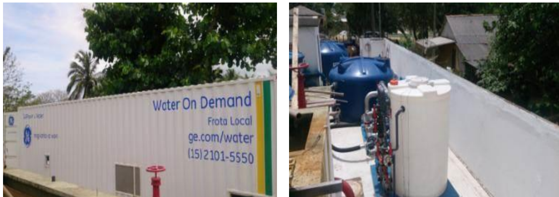
Imagens da Estação de Tratamento Móvel
