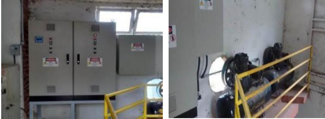
Mosaico de imagens evidenciando o painel de alimentação e sistema de bombas anfíbias.
