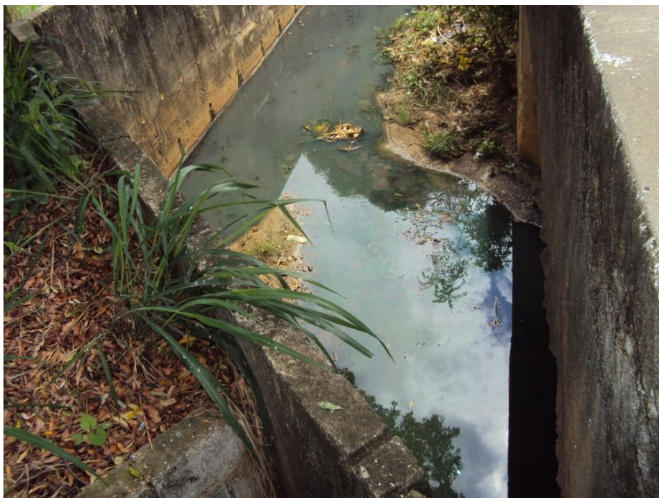
Figura 9 - Lançamento de esgoto na rede pluvial rua Baião, 293 na cidade de Aimorés.
