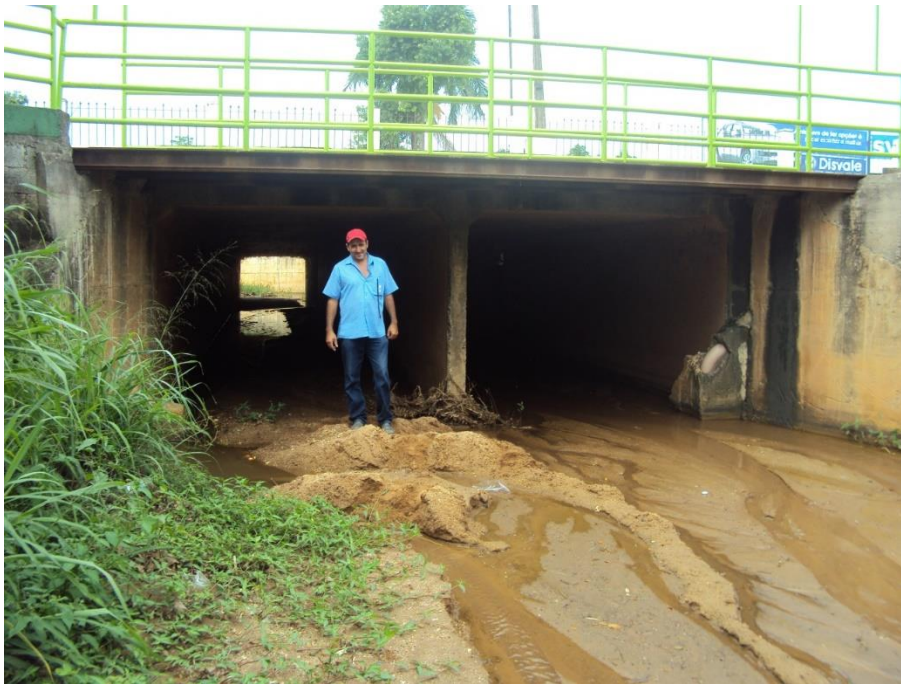
Figura 8 - Grande carga de sedimento e lançamento de esgoto in natura no Córrego do Chucha - Galeria ao lado da Parada Biribas.
