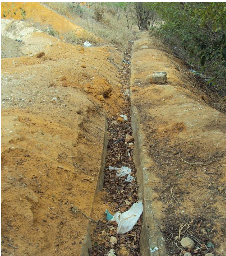
Figura 9 - Vista parcial da calha para a drenagem de água pluvial, construída na área da UTC/ aterro controlado, obstruída por solo e resíduos necessitando limpeza para a sua desobstrução.
