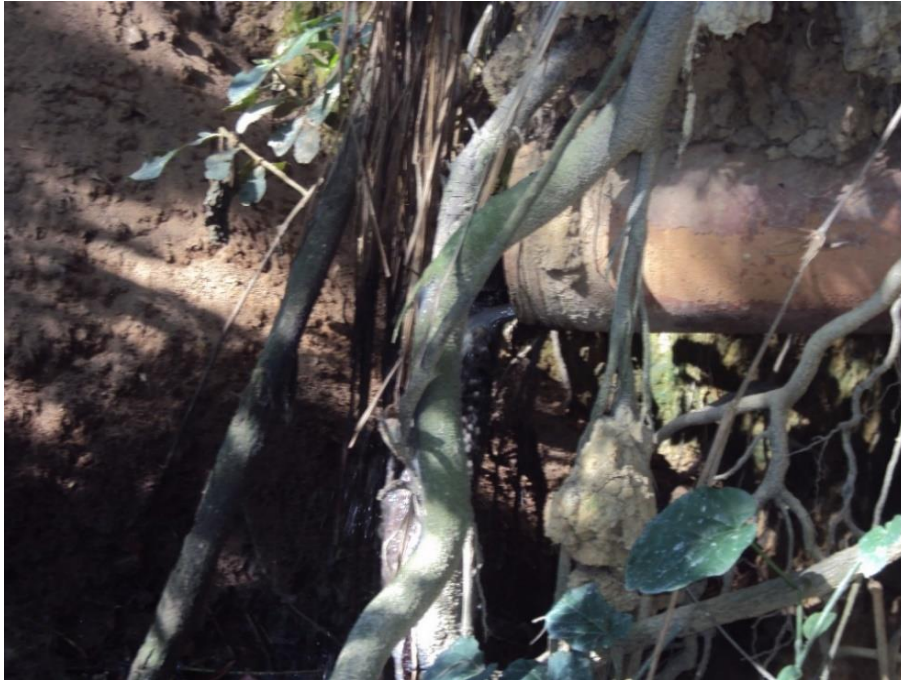
Figura 34 - Aspecto visual do lançamento de esgoto in natura , localizado no córrego Ibiruçu. (Local: 24K 0263583 7823801 / Altitude: 190 m).
