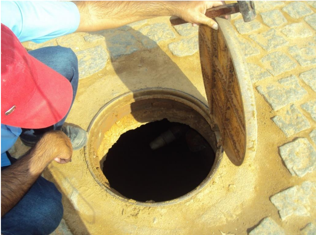
Figura 3 - Aspecto visual do extravasor de esgoto in natura na rede pluvial localizado próximo ao cruzamento da Avenida Brasil com a Rua Luiz Martins Soares. (Local: 24K 0283052 7842811/ Altitude: 79 m)
