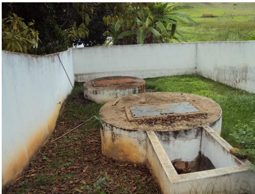
Figura 29 - Estação Elevatória próxima ao ponto de captação de água bruta (Local: 24K 0258917 7826208 / Altitude: 168 m).
