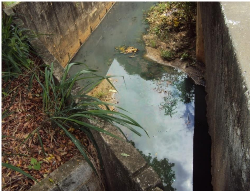
Figura 6 - Aspecto visual do lançamento clandestino de esgoto in natura localizado na Rua Baião, próximo à residência n° 293. (Local: 24K 0284267 7843582 / Altitude: 96 m).
