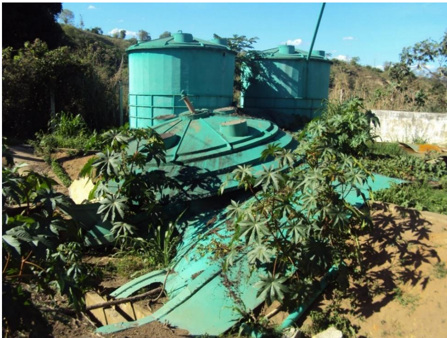
Figura 35 - Vista de parte da antiga ETE desativada devido a problemas estruturais. (Local: 24K 0263360 7823530 / Altitude: 179 m).
