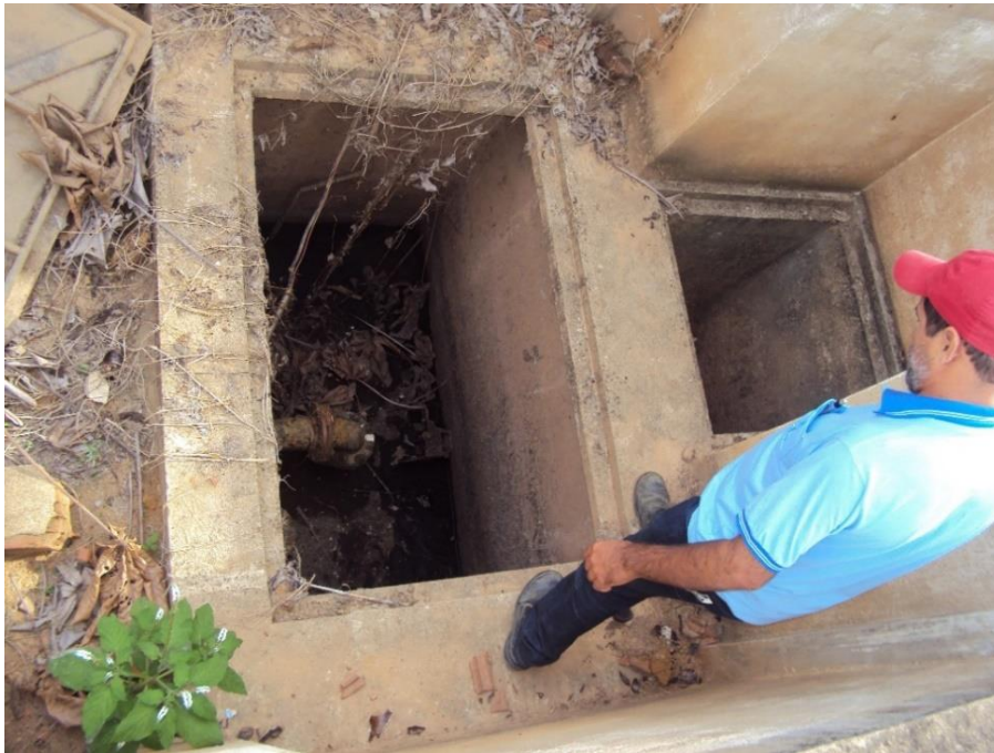
Figura 37 - Estação Elevatória no final da Rua Travessa Guarani (Local: 24K 0288805 7842110 / Altitude: 70 m).
