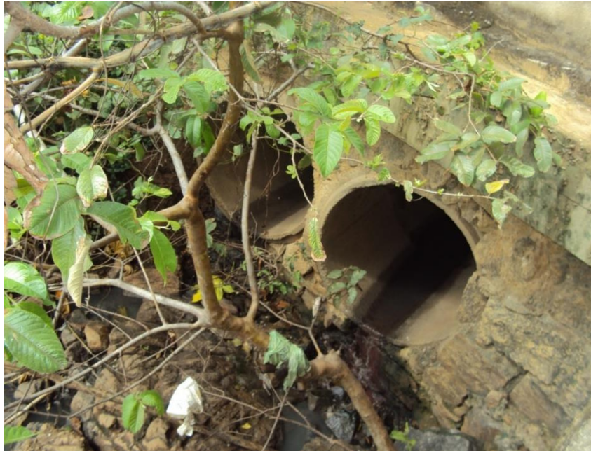
Figura 5 - Aspecto visual do lançamento clandestino de esgoto in natura localizado na Rua Cabo Benedito, próximo à residência n° 26. (Local: 24K 0284279 7843633 / Altitude: 94 m).
