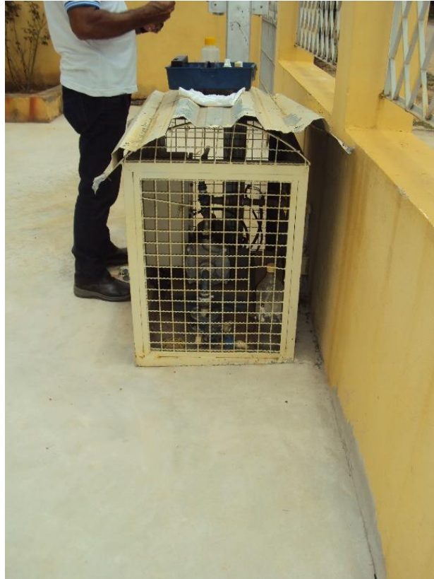
Figura 57 - Aspecto visual da estrutura de captação de água bruta realizado por meio de poço artesiano (Local: 24K 0264566 7818014 / Altitude: 211 m).
