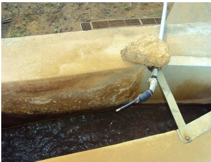
Figura 43 - Adição de Sulfato de Alumínio na água bruta (Local: 24K 0288435 7842556/ Altitude: 110 m).
