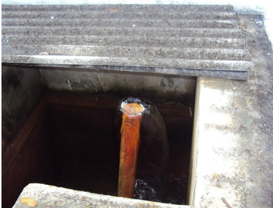
Figura 49 - Aspecto visual da entrada de água bruta na estação de tratamento (Local: 24K 0259014 7826177 / Altitude: 233 m).
