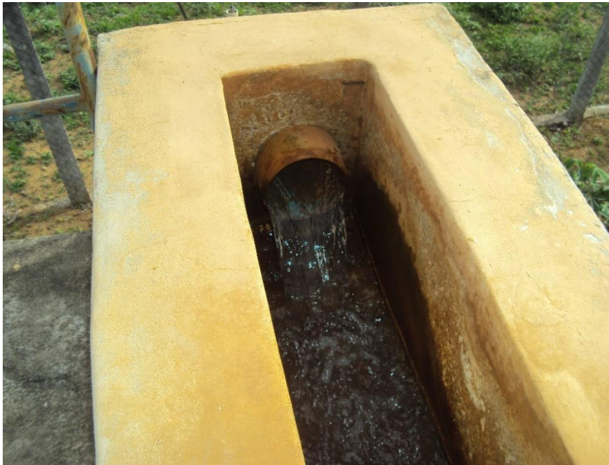
Figura 42 - Aspecto visual da entrada de água bruta na estação para tratamento (Local: 24K 0288435 7842556/ Altitude: 110 m).
