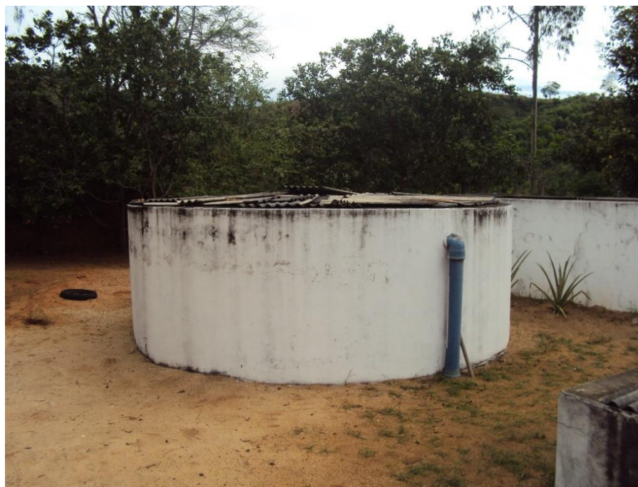
Figura 51 - Decantador (Local: 24K 0259014 7826177 / Altitude: 233 m).
