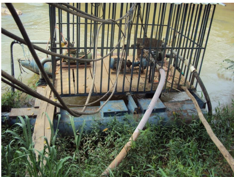
Figura 32 - Aspecto visual da captação de água bruta localizado no rio Manhuaçu (Local: 24K 0257430 7842313 / Altitude: 178 m).
