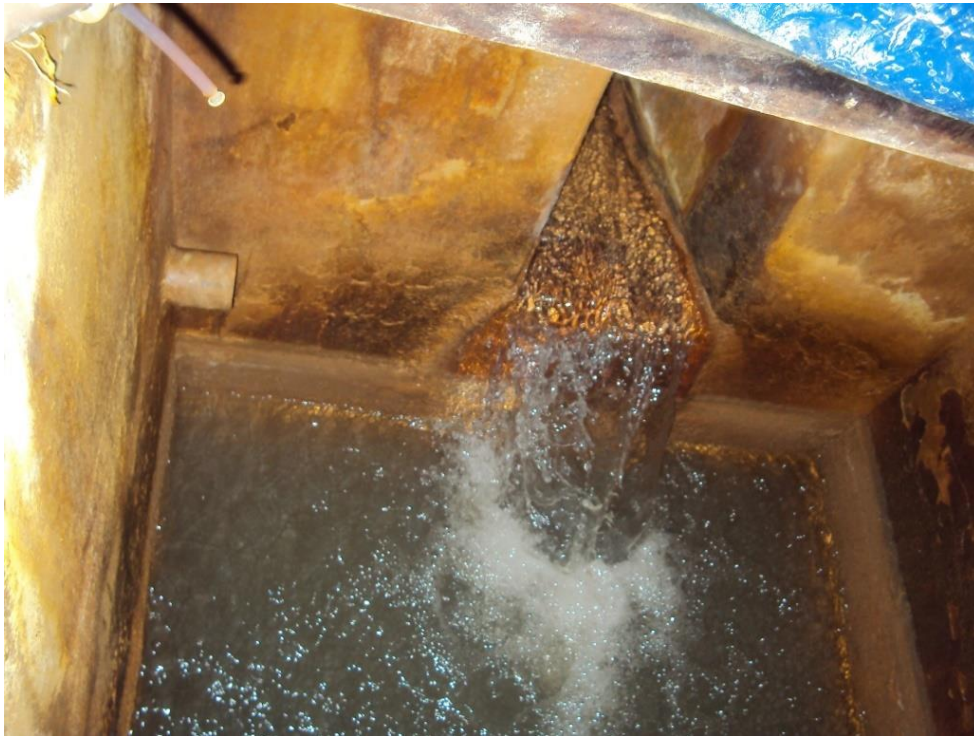
Figura 33 - Aspecto visual da entrada de água bruta na ETA (Local: 24K 0257631 7841957 / Altitude: 179 m).
