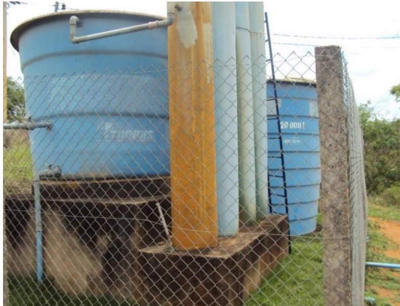
Figura 58 - Estação de Tratamento de Água (Local: 24K 0264463 7817859/ Altitude: 206 m).
