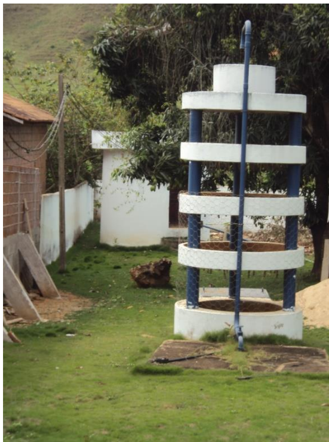
Figura 48 - Aspecto visual do poço de captação 1 de água bruta (Local: 24K 0258917 7826208 / Altitude: 208 m).
