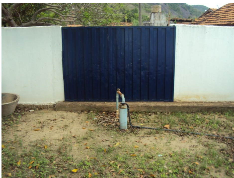
Figura 1 - Aspecto visual da captação de água bruta por meio de poço artesiano (Local: 24K 0253242 7815185/Altitude: 259 m).
