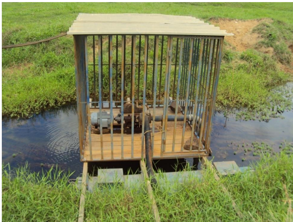
Figura 25 - Moto-bomba utilizada de captação de água bruta no córrego Vala do Ubá (Local: 24K 0264463 7817859 / Altitude: 215 m).
