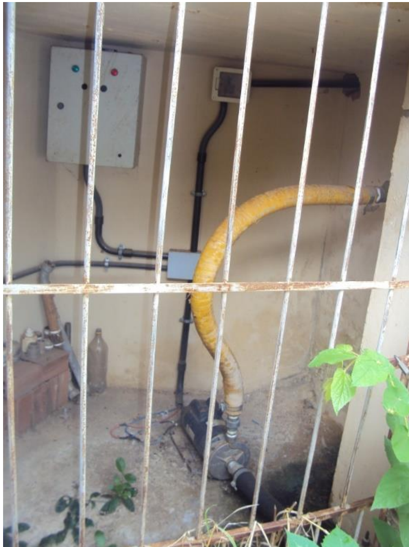
Figura 9 - Estação Elevatória do Sistema Aimorés no Morro do Anésio (Local: 24K 0281454 7842822/Altitude: 117 m).
