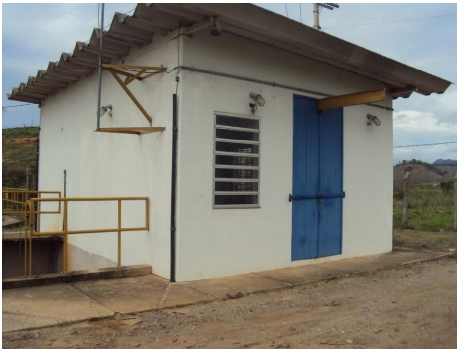
Figura 7 - Casa de Bombas (Local: 24K 0279712 7844239/Altitude: 88 m).
