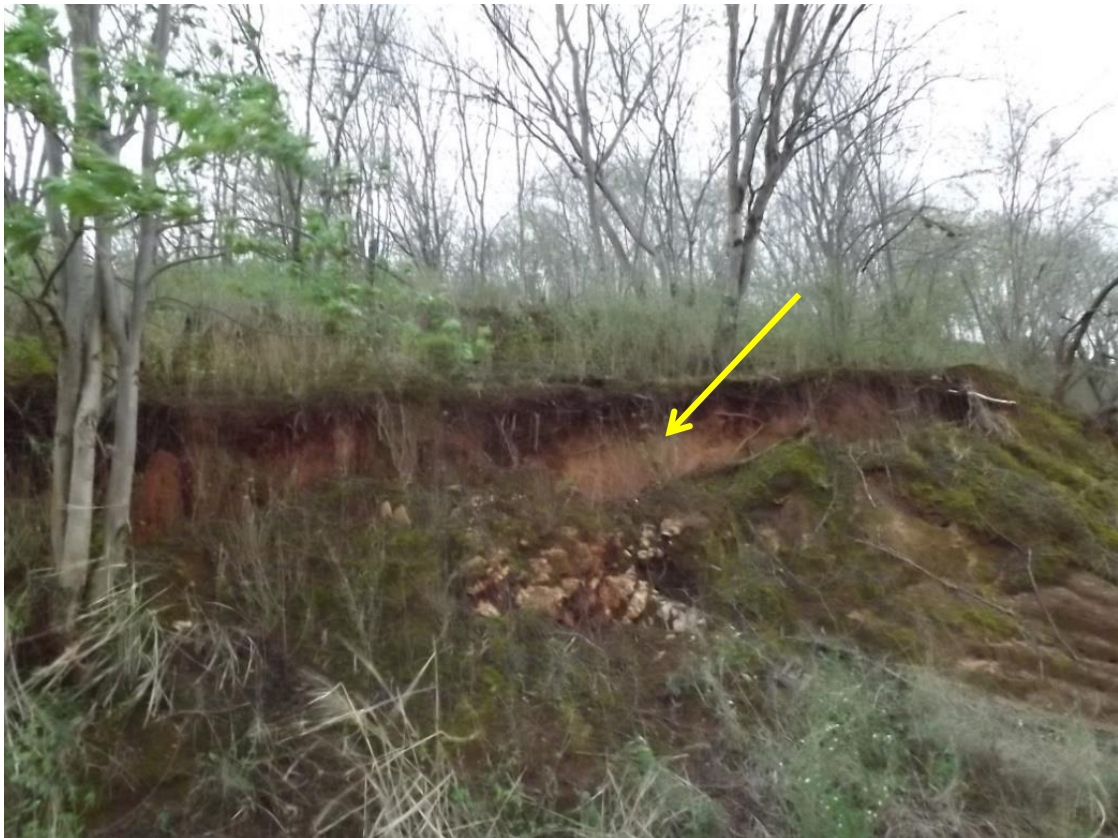
Figura 6 - Degrau oriundo de um deslizamento no Distrito de Tabaúna.
