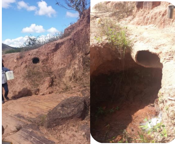
Adutora do Córrego Santaninha da COPASA.
