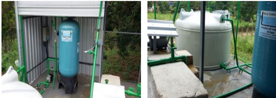
Imagem do filtro (à esquerda) e do reservatório (à direita) do sistema de tratamento da água do poço do distrito de São Tomé do Rio Doce.
