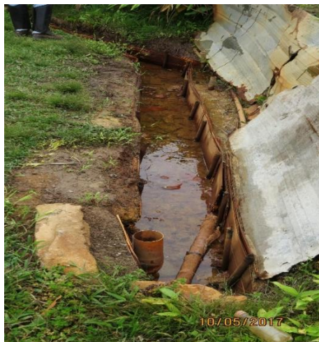
Captção em nascente para abastecimento do distrito de Pedras
