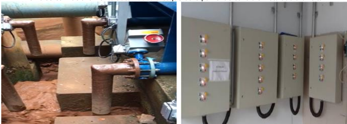
Válvulas com acionamento automático à esquerda e painel de controle instalado à direita.
