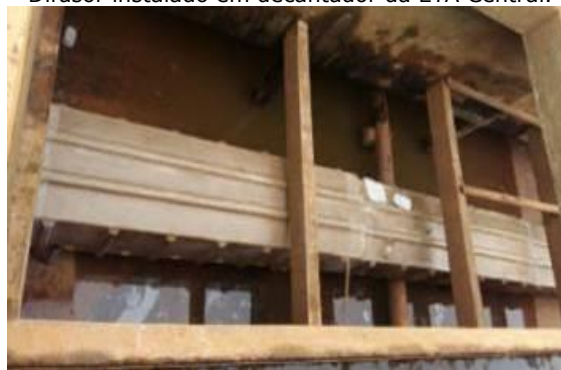
Difusor instalado em decantador da ETA Central.
