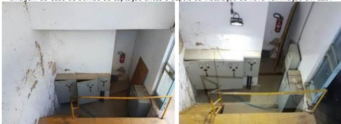
Imagem da Casa de Bomba de captação antes e depois da instalação de nova iluminação em LED.
