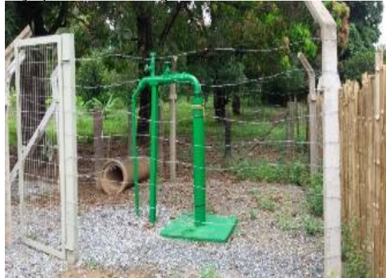
Área de sistema de captação por poço, que teve ação de melhoria.
