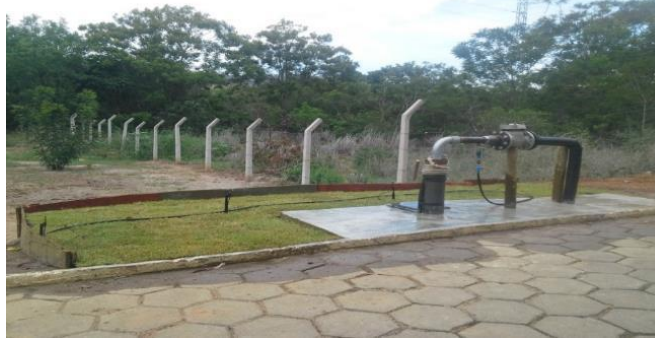
Imagem do poço de Mascarenhas interligado a ETA do distrito.
