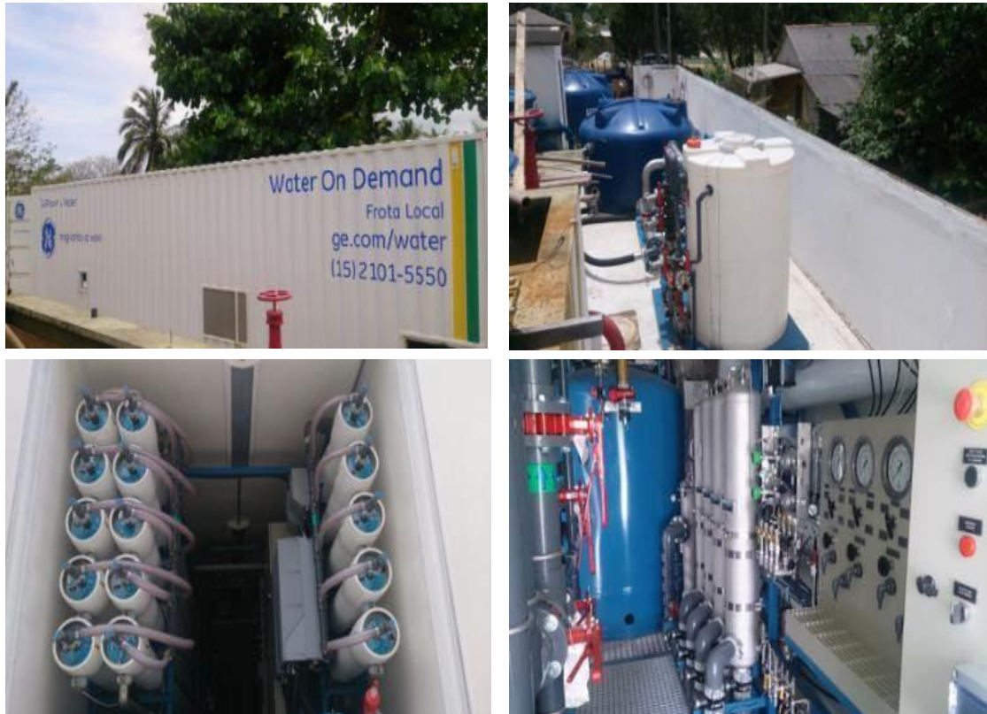
Imagens da Estação de Tratamento Móvel
