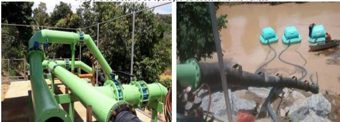
Imagens do sistema de operação da adutora no Rio Pancas
