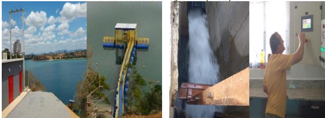
Sistema de Bombeamento e Subestação (esquerda) e Chegada de água no SAAE e painel de operação Remota da adutora de Lagoa Nova (direita).
