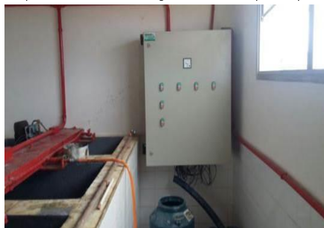
Montagem do pannel de comando dos agitadores dos tanques de produto químico
