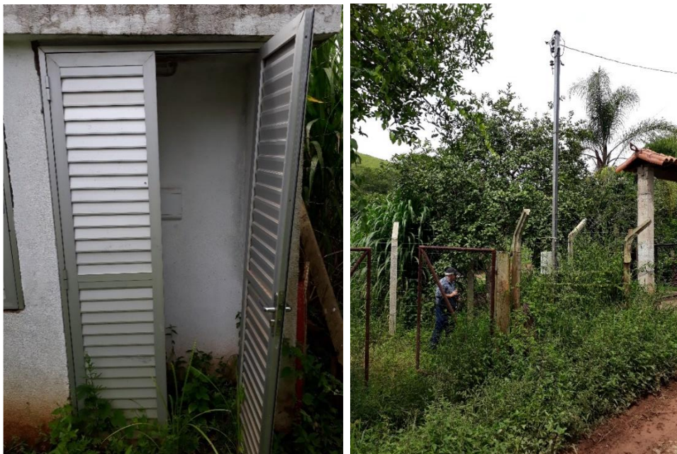
Estrutura construída no local do poço encontra-se danificada e sem uso (à esquerda) e Entrada do local onde está localizado o poço tubular (à direita)
