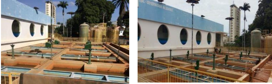
Imagens dos agitadores instalados na ETA Central.
